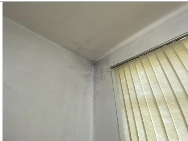
Foto 12 – Manchas de umidade no teto e paredes da sala do pedagógico do pav. Superior.
