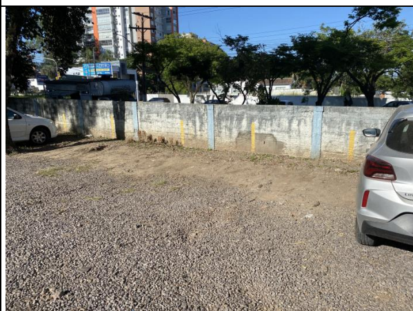
Foto 22 – Face interna dos muros laterais com pintura antiga e deteriorada.
