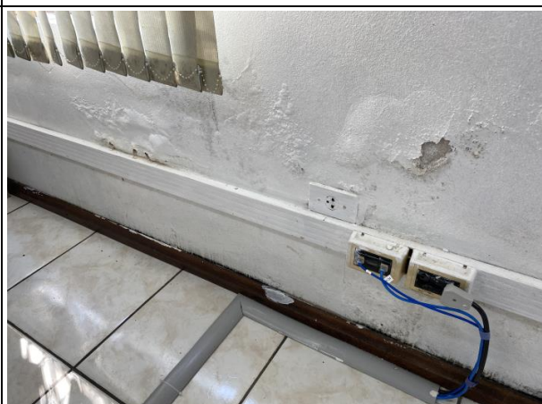
Foto 14 – Reboco com bolhas e manifestações patológica devido a umidade – Sala administrativo no pav. Térreo.
