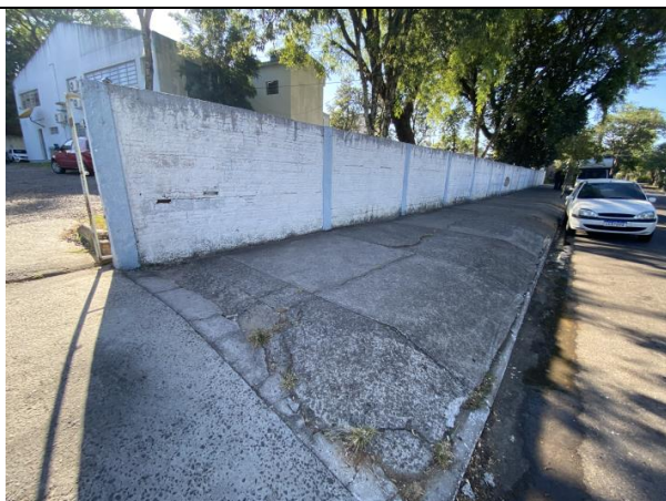
Foto 17 – Face externa dos muros laterais com pintura antiga e deteriorada.
