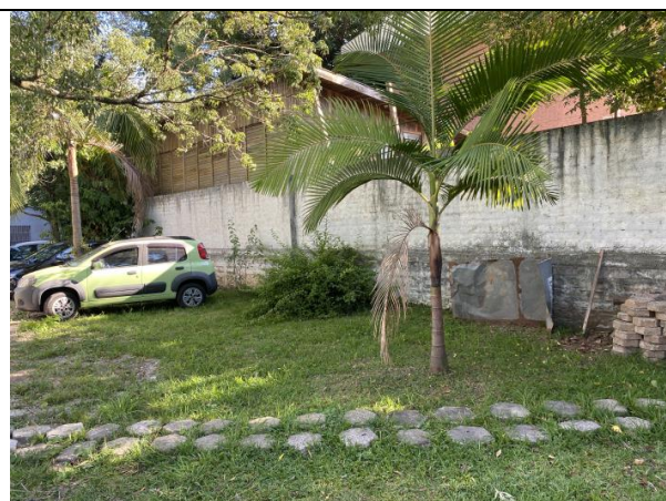
Foto 21 – Face interna dos muros da divisa lateral com pintura antiga e deteriorada.
