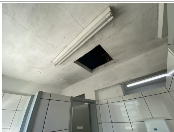
Foto 10 – Manchas de umidade no teto do banheiro do pav. Superior.
