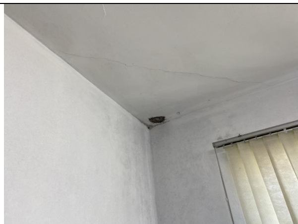
Foto 13 – Manchas de infiltração nas paredes e laje.
