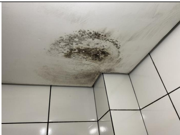
Foto 9 – Mancha de bolor no teto de gesso acartonado do banheiro do pav. Térreo.
