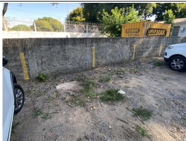
Foto 20 – Face interna dos muros de divisa dos fundos sem pintura e revestimento irregular.
