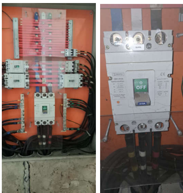
Quadro Geral de Baixa Tensão de acordo e instalado corretamente.
