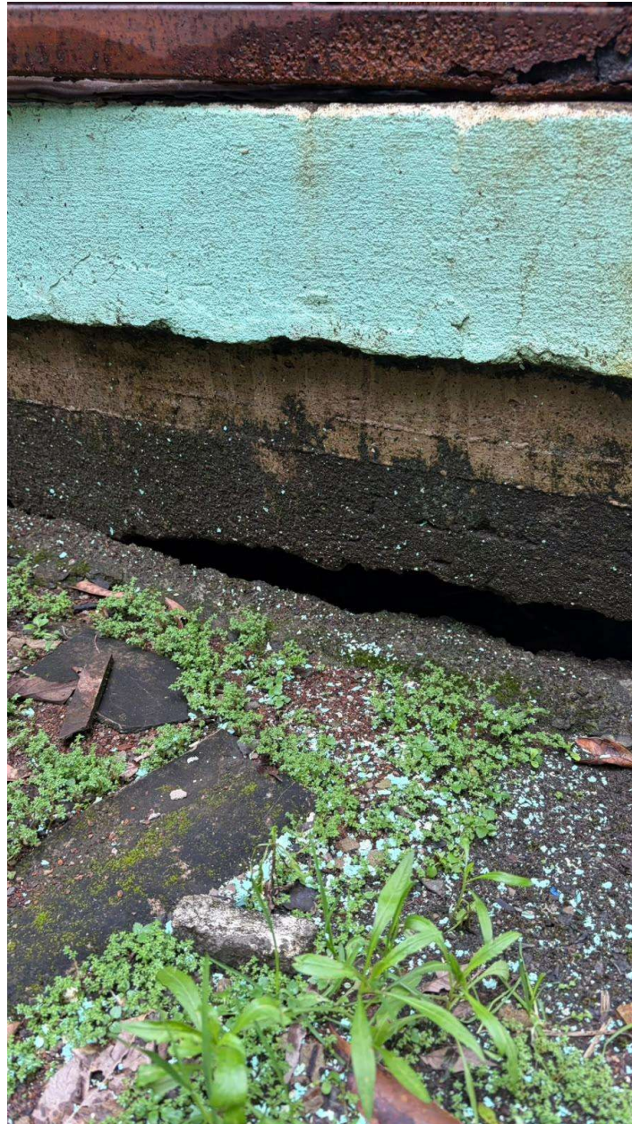
Figura 26: Manifestação de recalque diferencial no canto externo esquerdo do ginásio.
