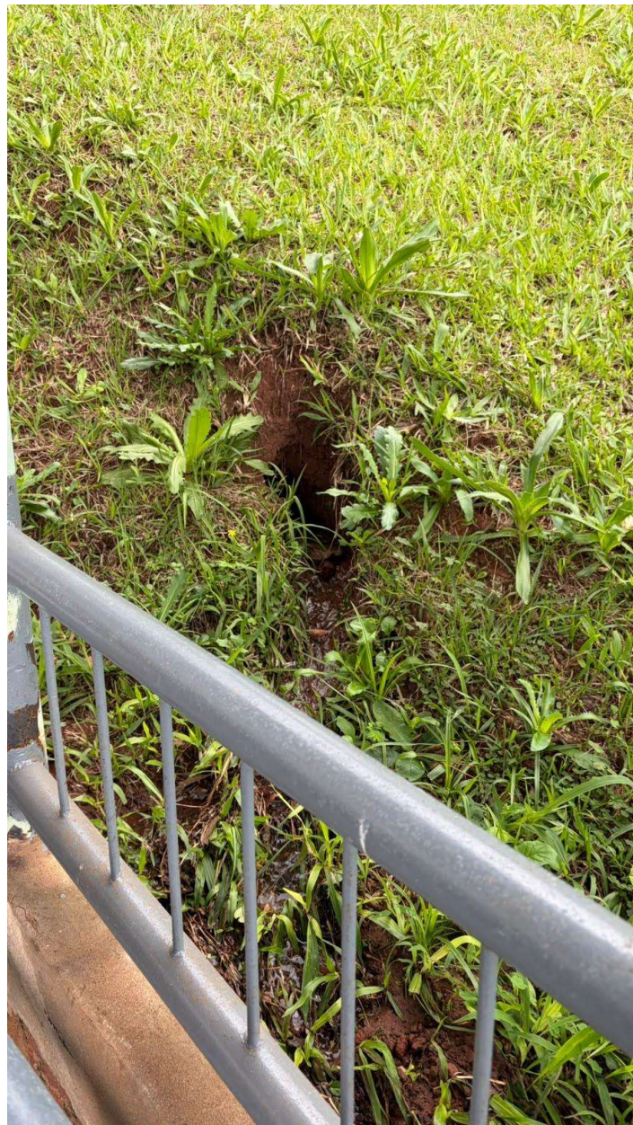
Figura 7: Cavidade no solo do talude da escola.
