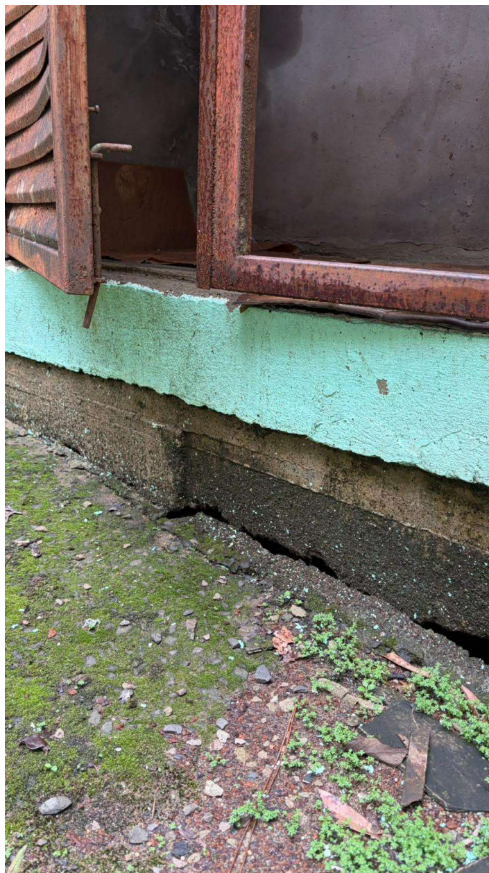
Figura 28: Manifestação de recalque diferencial no canto externo esquerdo do ginásio.
