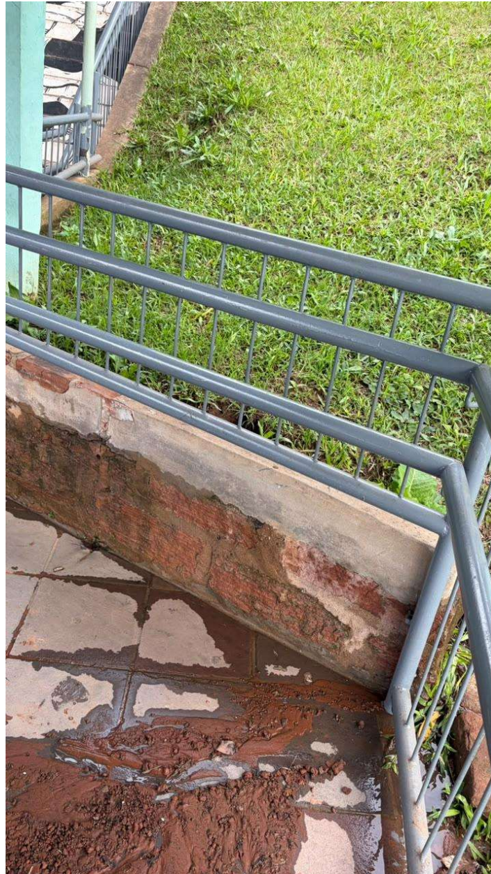
Figura 11: Resíduo de solo proveniente de uma das cavidades do talude.
