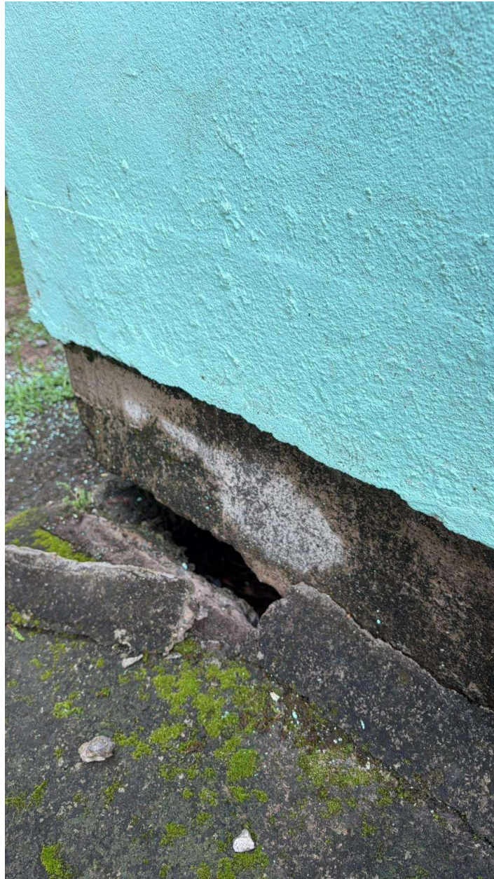
Figura 25: Manifestação de recalque diferencial no canto externo esquerdo do ginásio.
