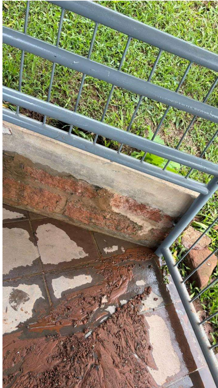
Figura 12: Resíduo de solo proveniente de uma das cavidades do talude.
