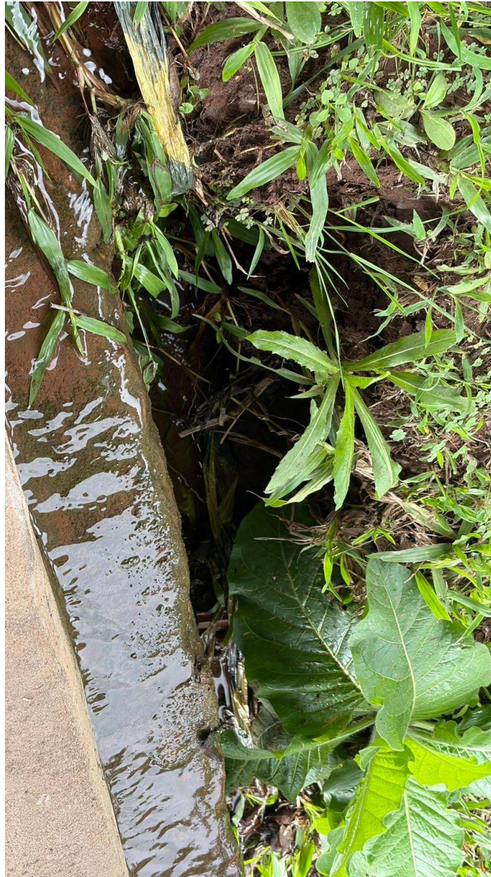
Figura 8: Cavidade no solo do talude e presença de água constante.
