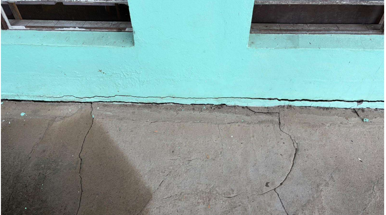
Figura 20: Rachadura longitudinal no ginásio.
