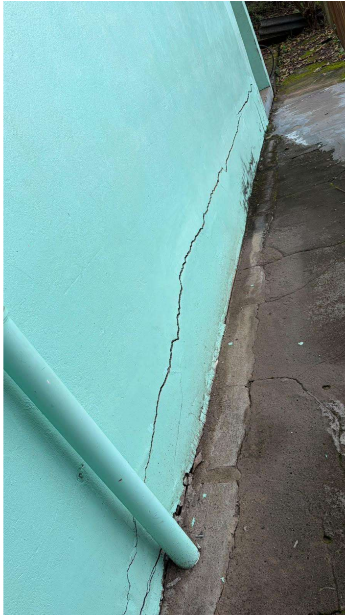
Figura 22: Rachadura longitudinal no ginásio.
