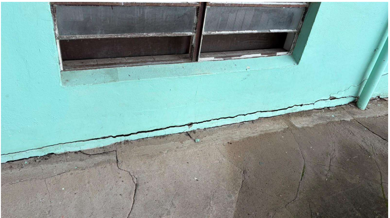
Figura 21: Rachadura longitudinal no ginásio.
