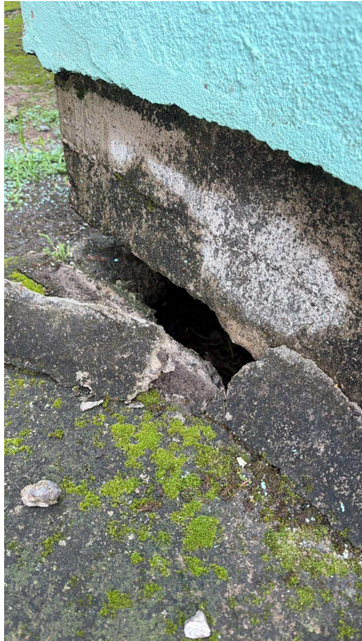
Figura 24: Manifestação de recalque diferencial no canto externo esquerdo do ginásio.
