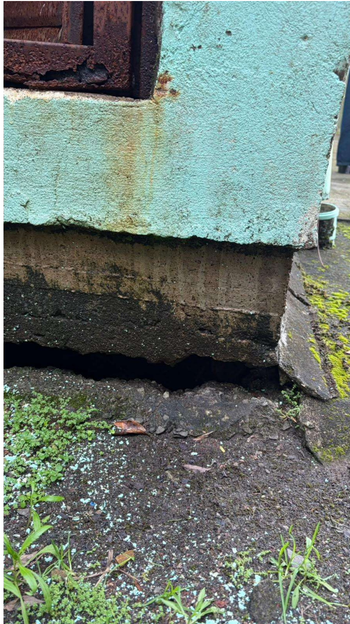
Figura 27: Manifestação de recalque diferencial no canto externo esquerdo do ginásio.
