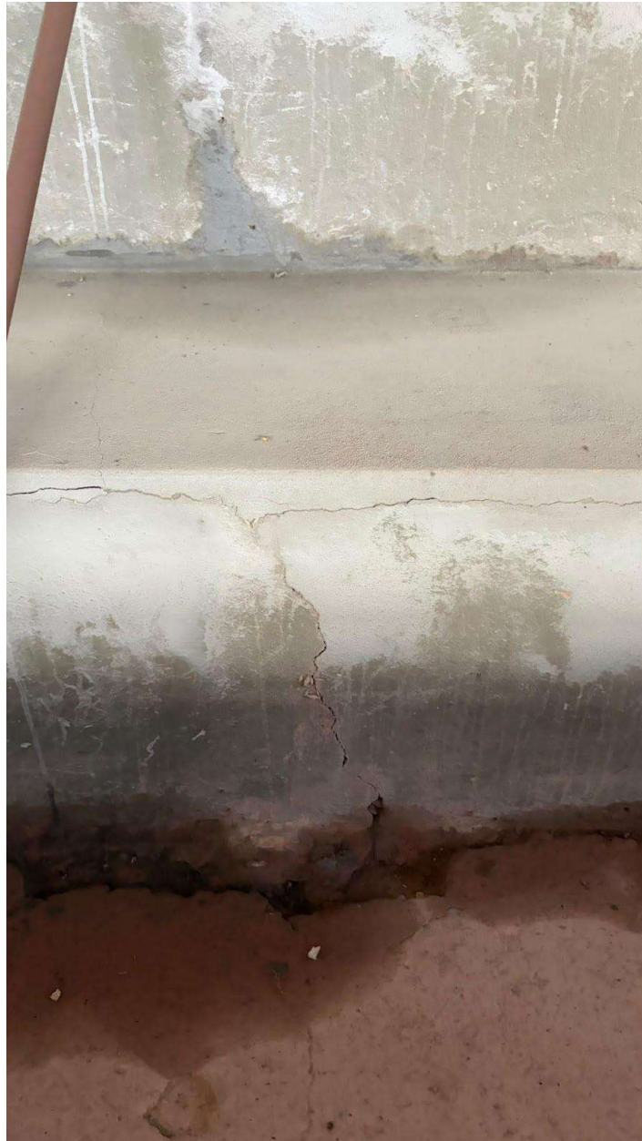
Figura 34: Manifestação patológica na arquibancada do ginásio.
