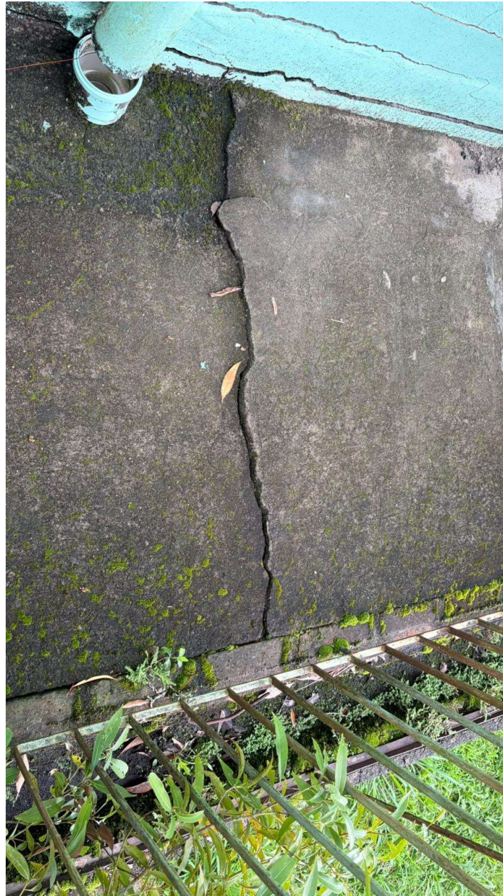
Figura 29: Rachadura associada ao afundamento no passeio de acesso ao ginásio.
