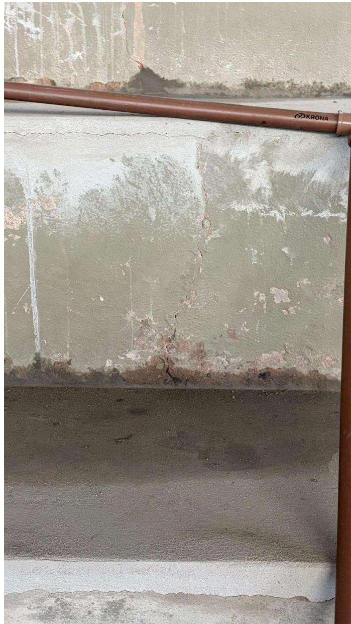
Figura 33: Manifestação patológica na arquibancada do ginásio.
