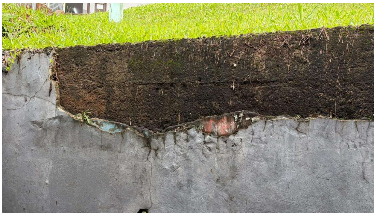
Figura 4: Camadas de massa que evidenciam os reparos já feitos no muro.
