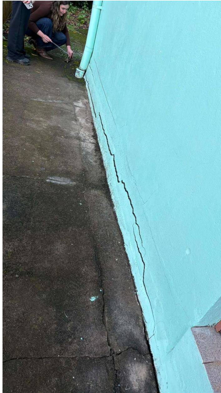
Figura 23: Rachadura longitudinal no ginásio.
