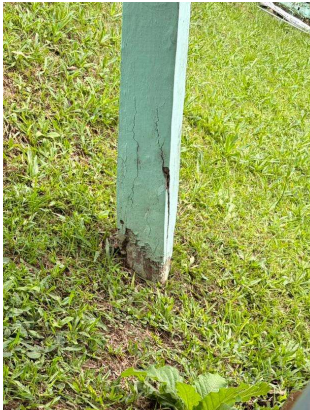
Figura 16: Vista lateral do pilar apresentando rachadura.
