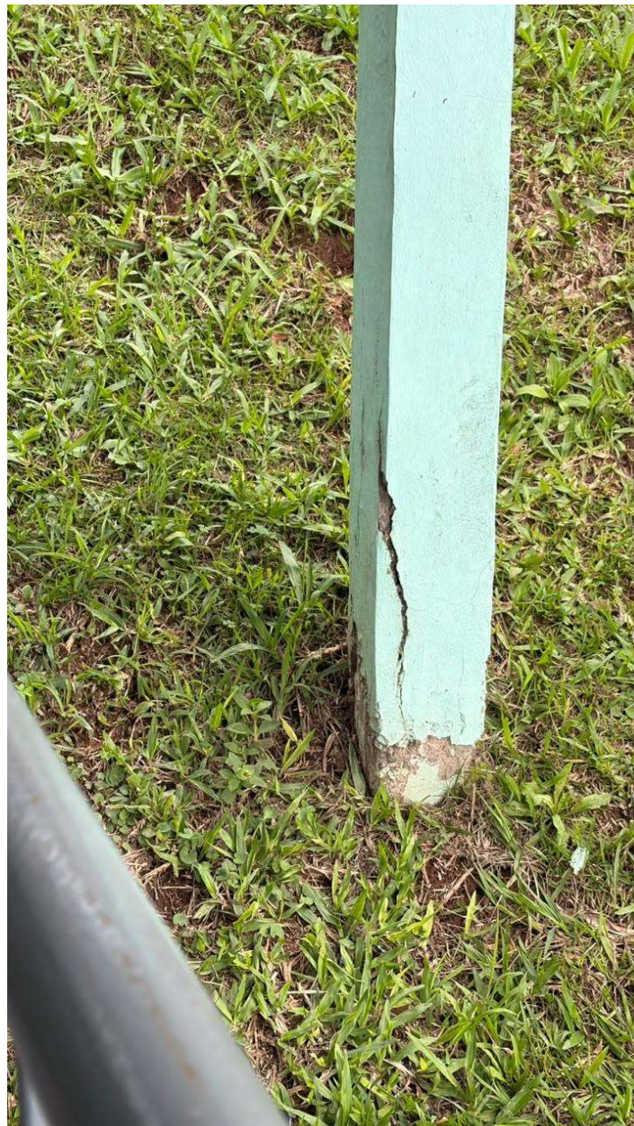
Figura 15: Vista frontal do pilar apresentando rachadura .
