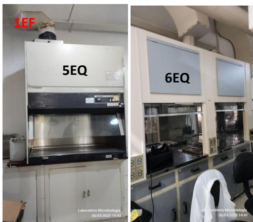
Capelas de fluxo laminar e exaustão a serem reposicionadas.
