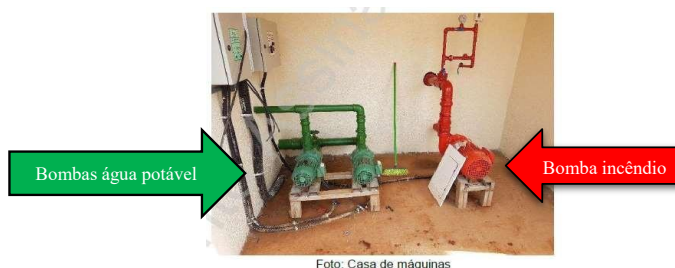
Foto: Casa de máquinas
