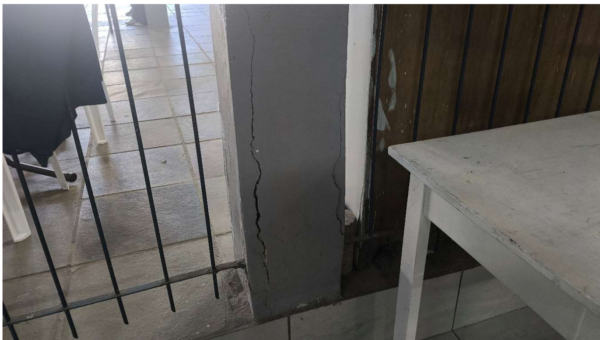
Imagem 05: Vista de pilar próximo também com patologia.
