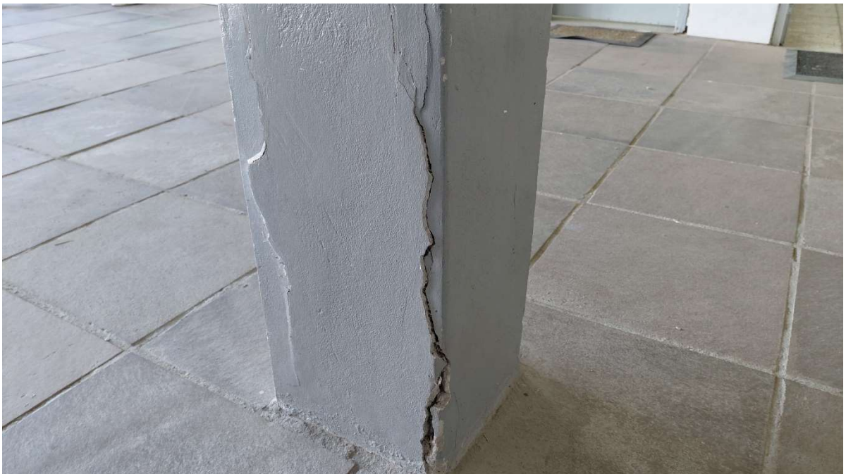
Imagem 04: Vista de pilar próximo também com patologia.
