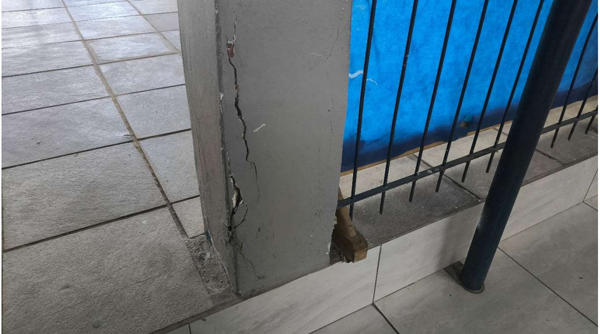
Imagem 03: Vista de pilar próximo também com patologia.
