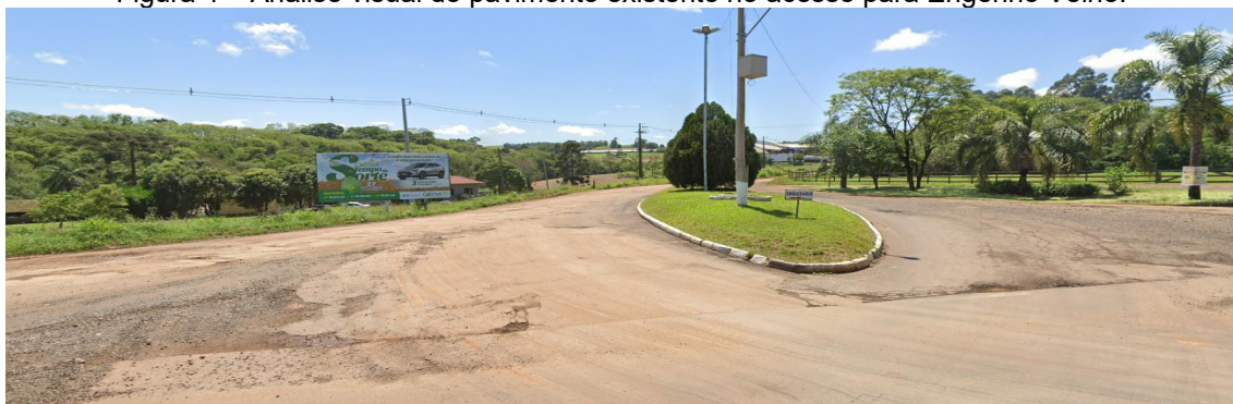
Figura 4 – Análise visual do pavimento existente no acesso para Engenho Velho.
