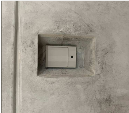
Figura 10- Entrada de Energia Elétrica
