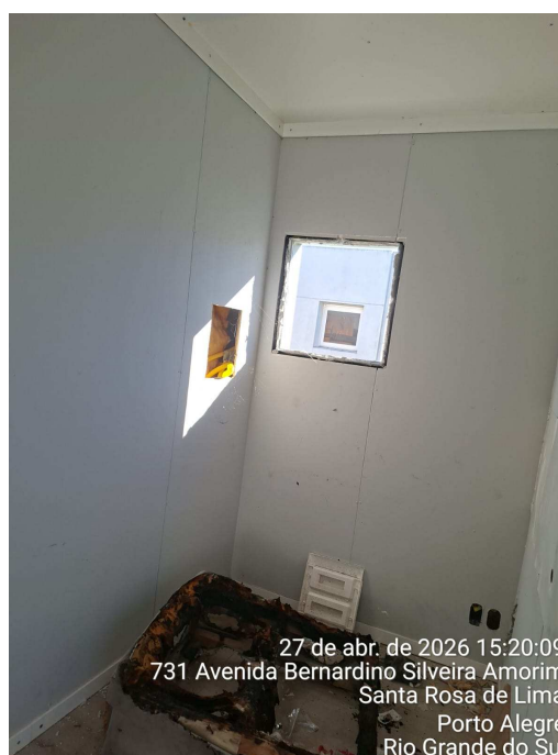
Foto 10 – Sistemas e elementos danificados
