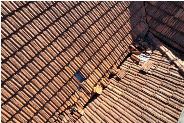
F05 – Vista parcial mostrando a deterioração da cobertura e que abaixo das telhas francesas existem chapas de zinco
