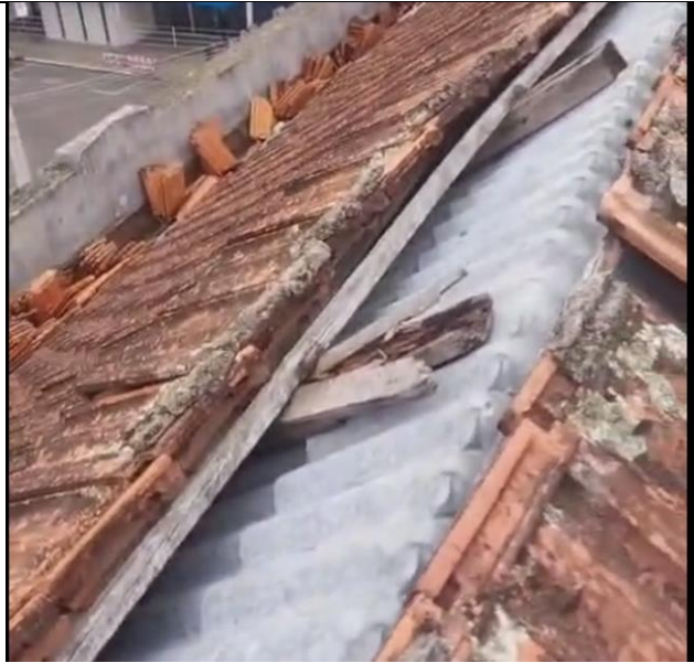
F06 – Vista parcial mostrando a deterioração da cobertura e que abaixo das telhas francesas existem chapas de zinco
