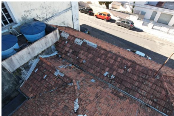
F03 – Vista parcial da cobertura mostrando recuperações parciais antes executadas já deterioradas
