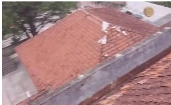
F11 – Vista da cobertura de apenas um nível (atrás do bloco maior já com deteriorações)
