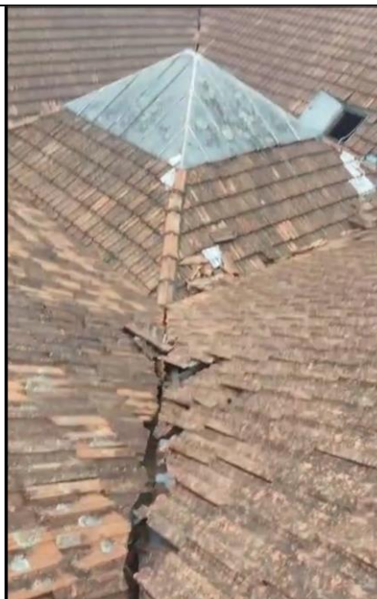
F10 – Vista parcial do telhado deteriorado com destaque para calha com escoamento interrompido
