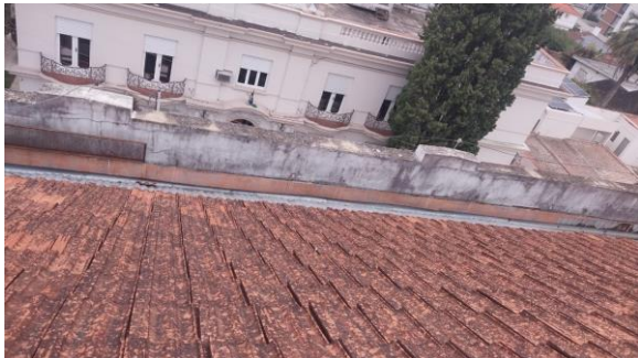
F07 – Vista mostrando parte das calhas deterioradas
