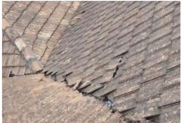
F08 – Vista parcial do telhado deteriorado com destaque para calha com escoamento interrompido
