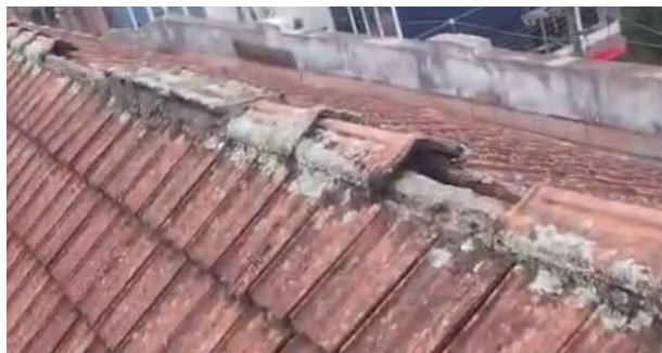
F12 – Vista de parte da cobertura mostrando cumeeira totalmente deterioradas
