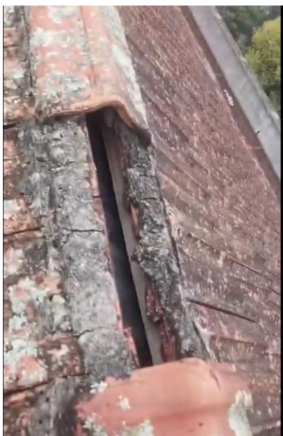
F09 – Vista com detalhe de cumeeira totalmente deteriorada
