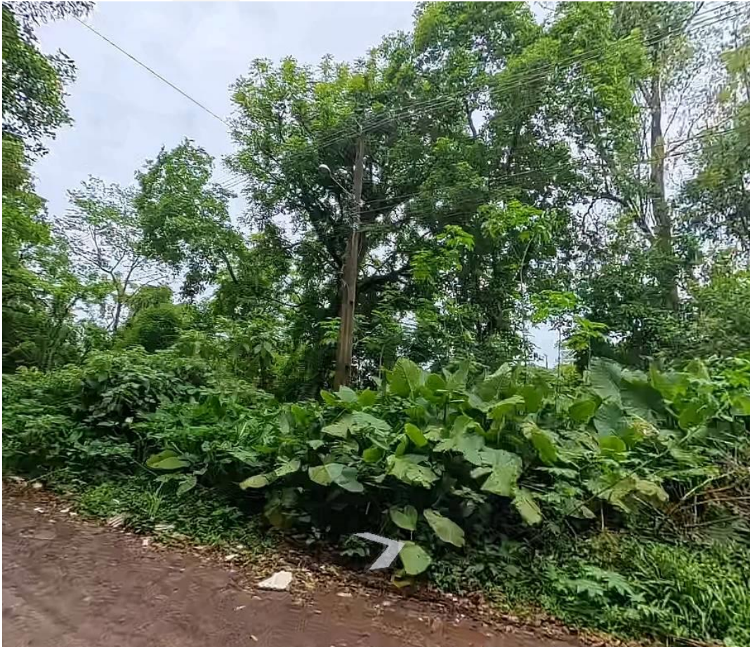
Imagem 10 - Poste P03 - CE1
