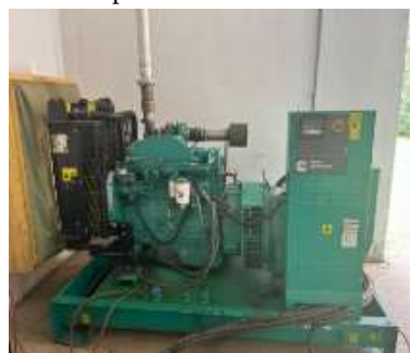
Grupo Gerador Cummins
