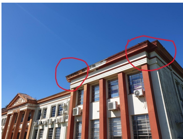
foto 5: fachada principal lado sul, local demarcado indica , onde deverá ser escorado/suportado a marquise
