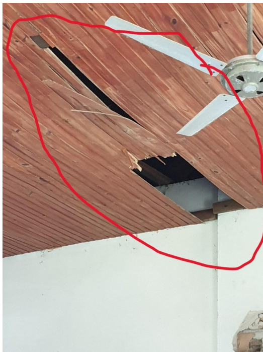
figura 7 - forro de madeira, sala do Gerador/lavanderia local demarcado em vermelho indica forro em situação de risco, deverá ser refeito
