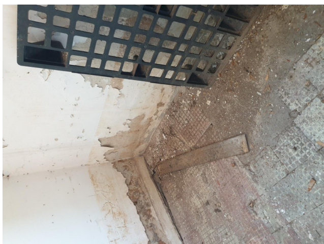
Foto 9: piso da sala do Gerador que cedeu, necessário refazer
