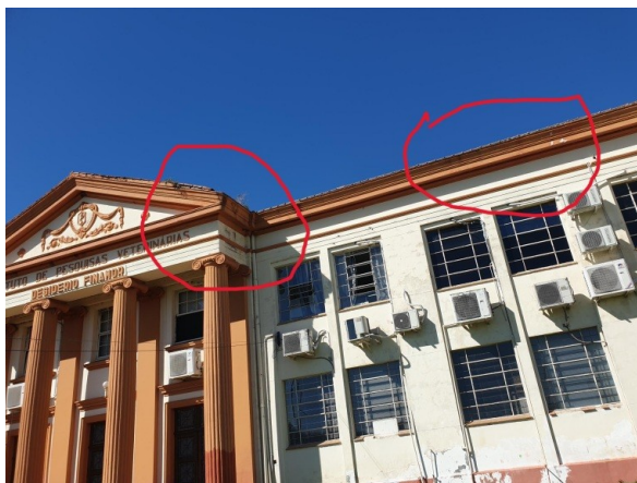
foto 4: local demarcado em vermelho indica, onde deverá ser feito o escoramento/suportação da marquise, lado sul fachada principal
