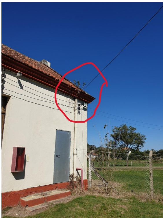
foto 8 – parte externa sala do Gerador/lavanderia, área demarcada em vermelho indica local onde deverá ser escorado o telhado
