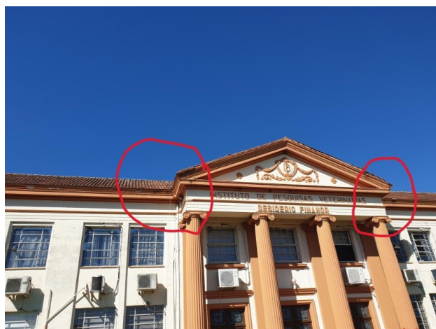
Foto 3: fachada principal sul pontos demarcados em vermelho indica, onde deverá ser escorado/suportado a marquise
