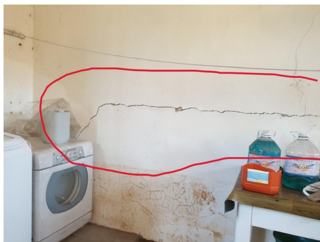
Foto 7: Lavanderia – local demarcado em vermelho indica, trinca expandida ao longo de toda parede
