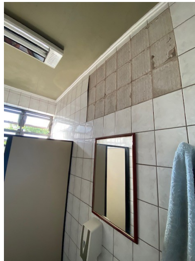
Figura 17 – queda de revestimento em banheiro
