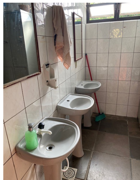
Figura 15 – banheiro com cubas sem torneiras
