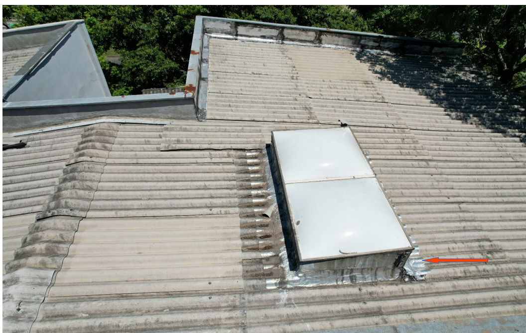
Figura 08 – domo de iluminação
