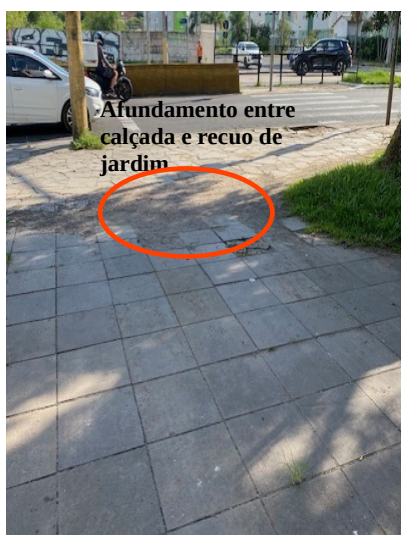
Figura 04 – desnivelamento na calçada
