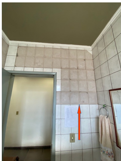
Figura 16 – queda de revestimento em banheiro
