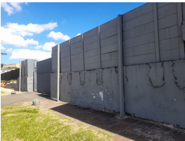
Foto 9: Muro existente com trincas
