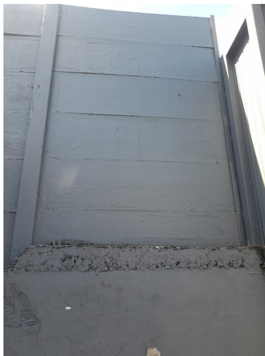
Foto 8: Muro existente com trincas
