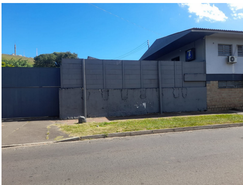
Foto 6: Muro existe com 11, 30 m com rachaduras
