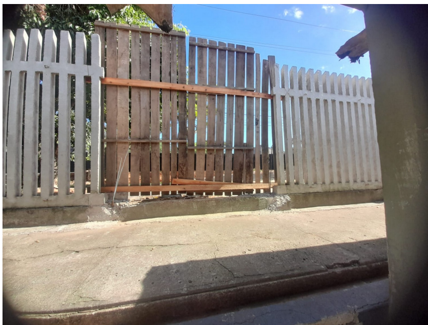
Foto 11 – Muro faltando no primeiro com 6,00m de largura do centro de treinamento físico Pedro e Paulo.
