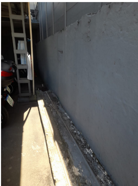
Foto 7: Muro existente com trincas
