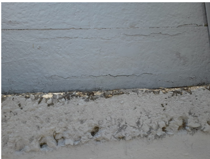
Foto 11 - Detalhe da foto Trincas no muro existente
