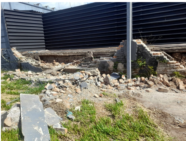
Foto 3: falta de muro e canalização de água quebrada.
