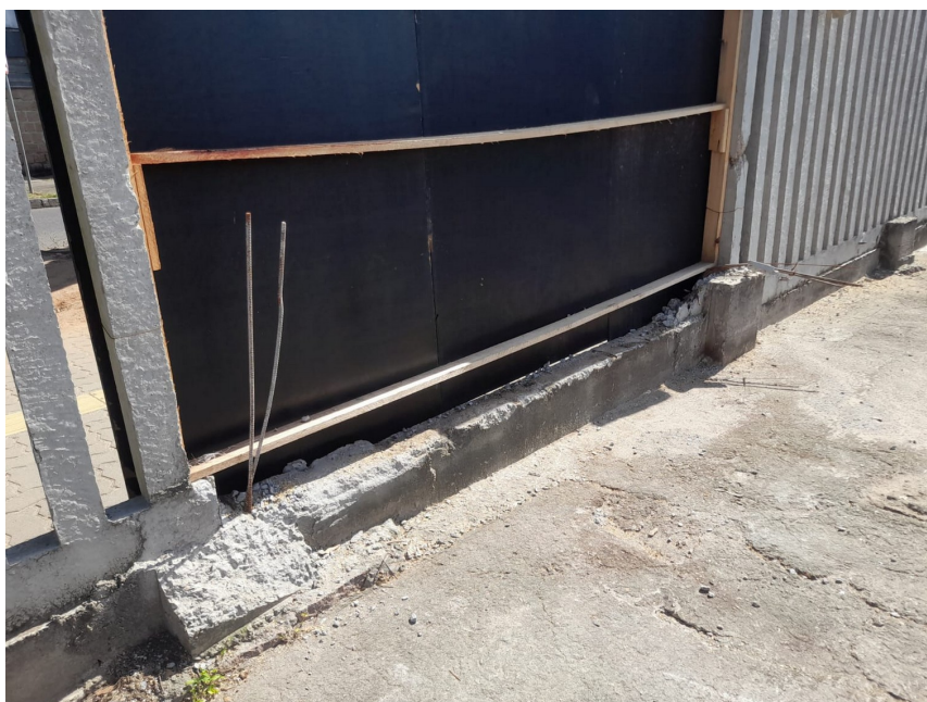
Foto 14 - Muro faltando no segundo tirada no trecho tirada dentro do centro de treinamento físico Pedro e Paulo.
