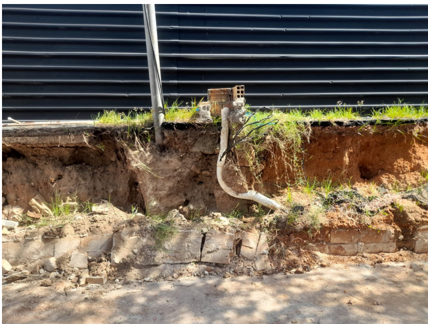
Foto 2: Fiação solta junto a terra e canalização de água quebrado.
