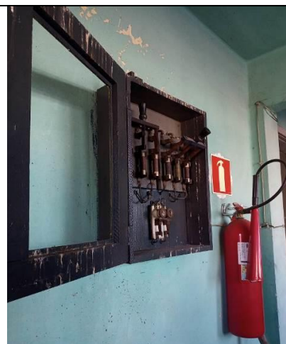
Fotografia 27 Painel elétrico existente na casa de máquinas
