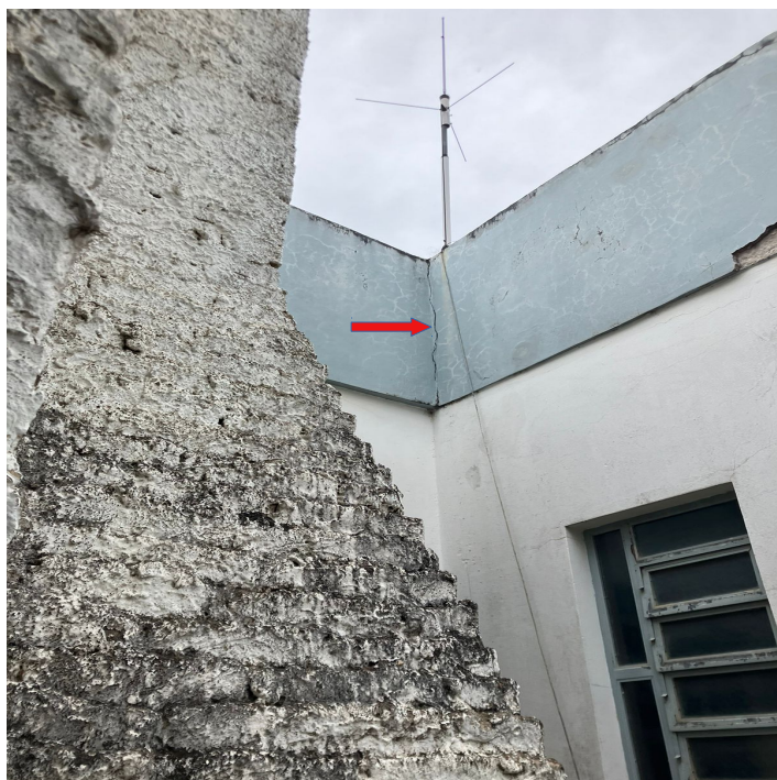
26 – Fissura na interface das platibandas – Platibanda da Lateral Esquerda da Edificação.
