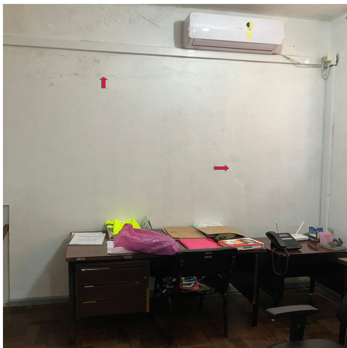
50 – Fissuras na Parede – Sala.
