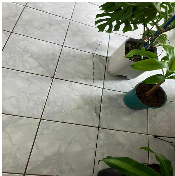
42 – Piso Solapado e Revestimento Cerâmico Rachado – Sala.
