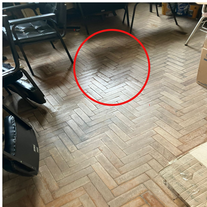
34 – Piso Deteriorado – Sala.
