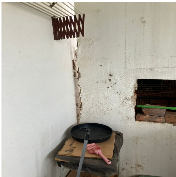
24 – Churrasqueira Inclínada devido ao solapamento do piso – Lateral Esquerda da Edificação.
