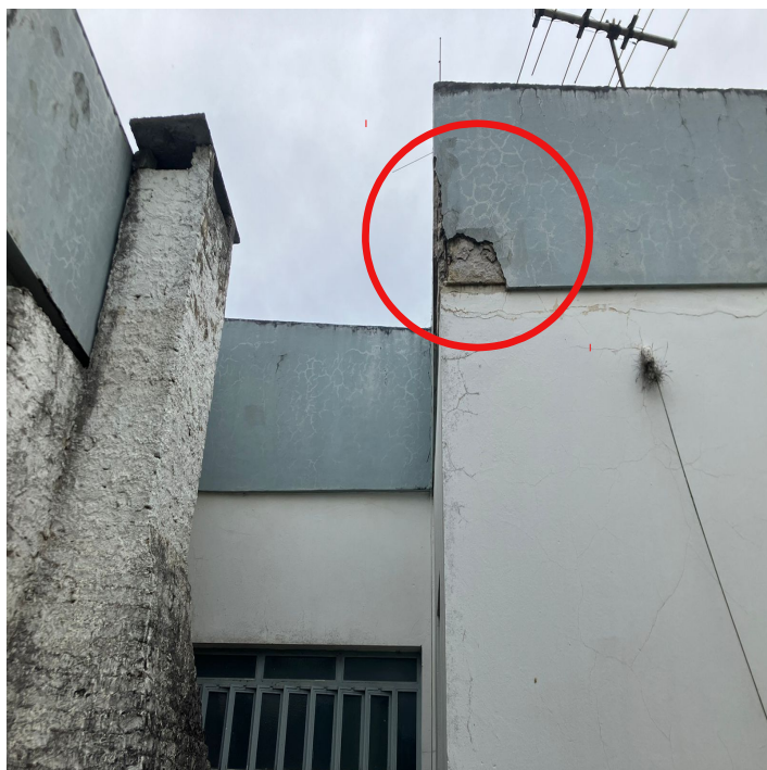
25 – Concreto Desplacado e Armadura Exposta – Platibanda da Lateral Esquerda da Edificação.
