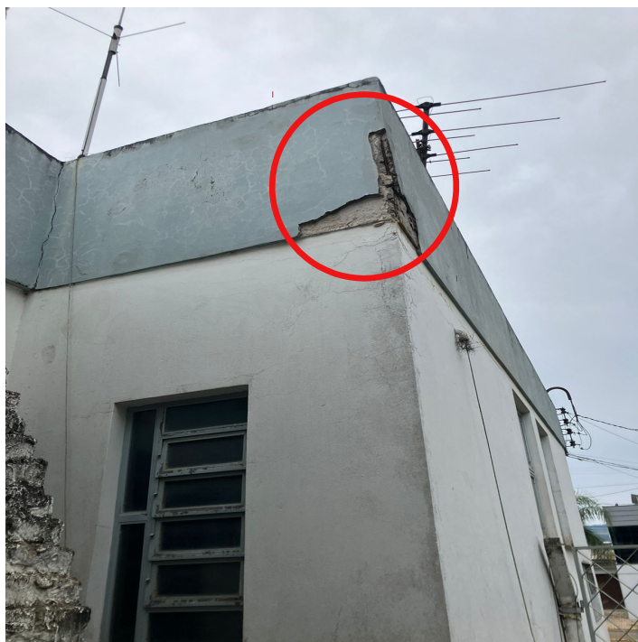
27 – Concreto Desplacado e Armadura Exposta – Platibanda da Lateral Esquerda da Edificação.
