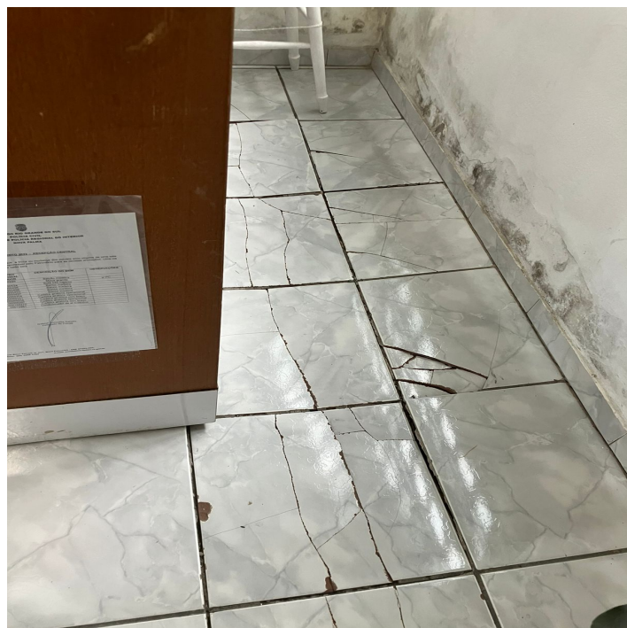
41 – Piso Solapado e Revestimento Cerâmico Quebrado – Sala.
