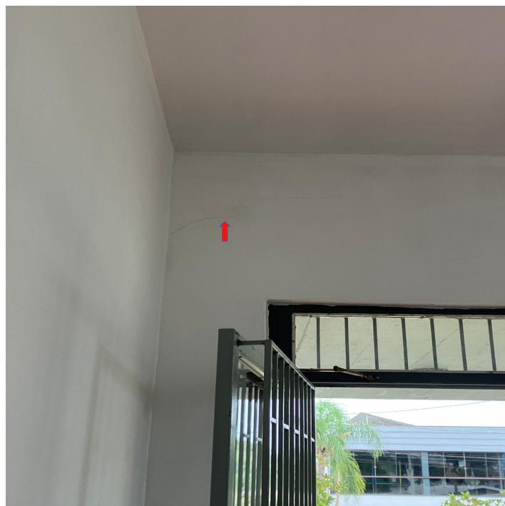
52 – Fissura na Parede – Sala.
