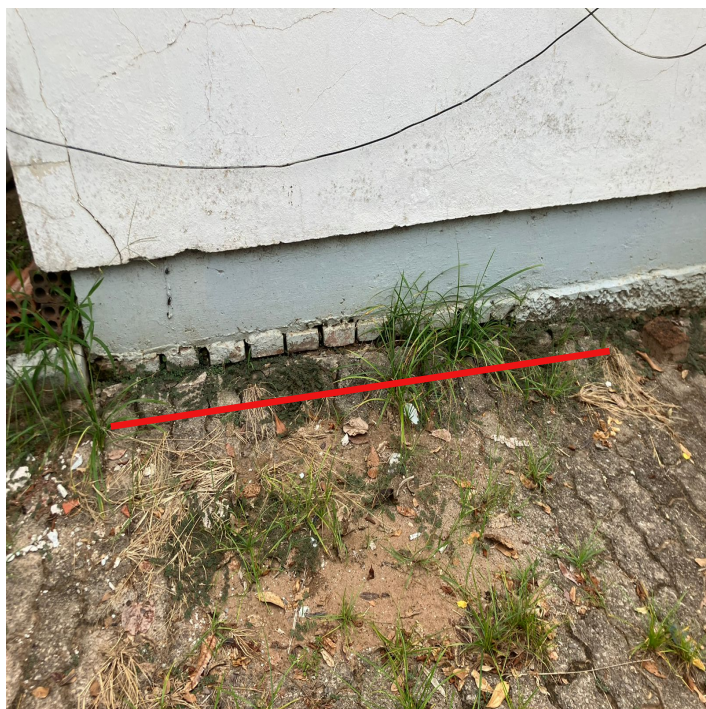
21 – Presença de Tijolos maciços sob a viga de fundação – Lateral Esquerda da Edificação.
