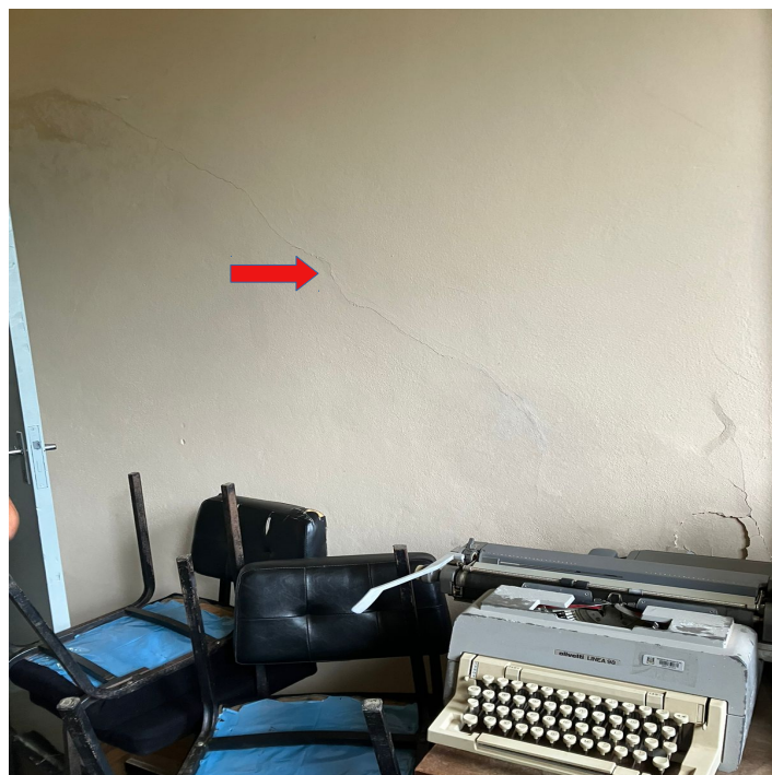
35 – Fissura na Parede – Sala.
