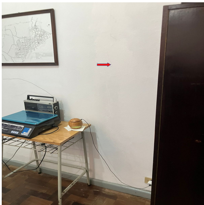
44 – Fissuras na Parede – Sala.
