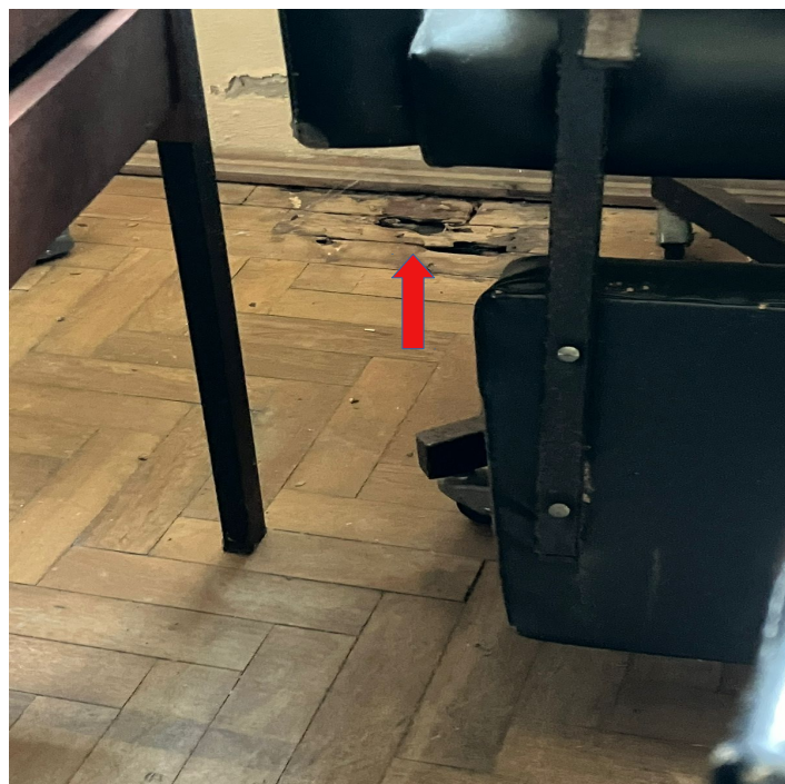
36 – Piso Deteriorado – Sala.
