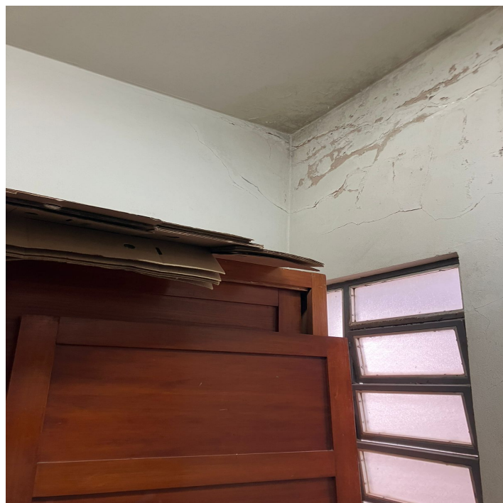
29 – Pintura Descamada na Parede – Sala.
