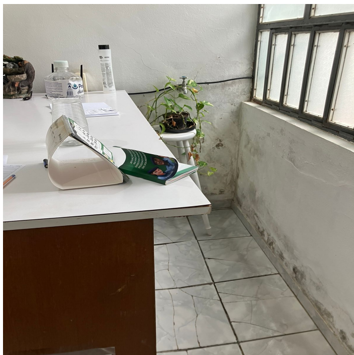
40 – Manchas de Bolor e Umidade na Parede / Piso Solapado e Revestimento Cerâmico Quebrado – Sala.
