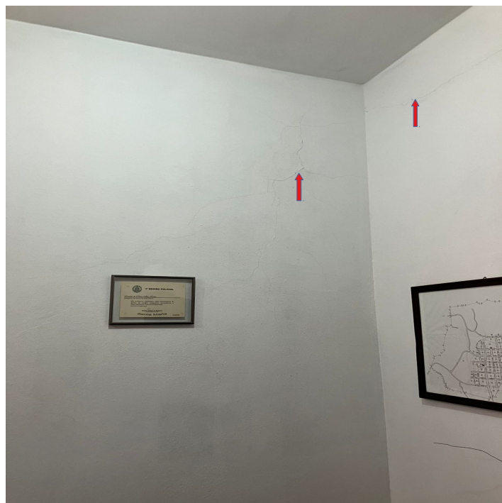
46 – Fissuras na Parede – Sala.
