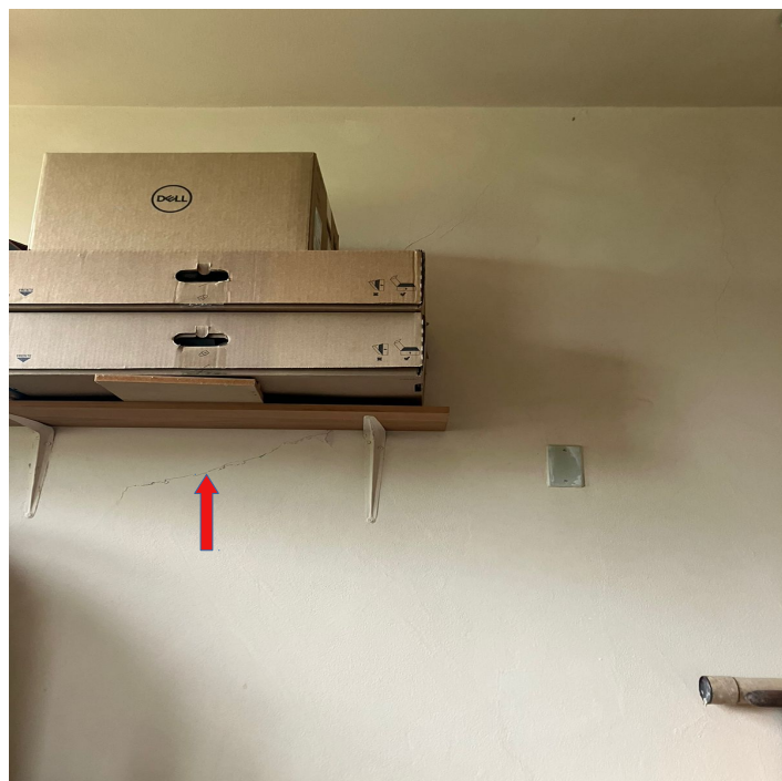
38 – Fissura na Parede – Sala.
