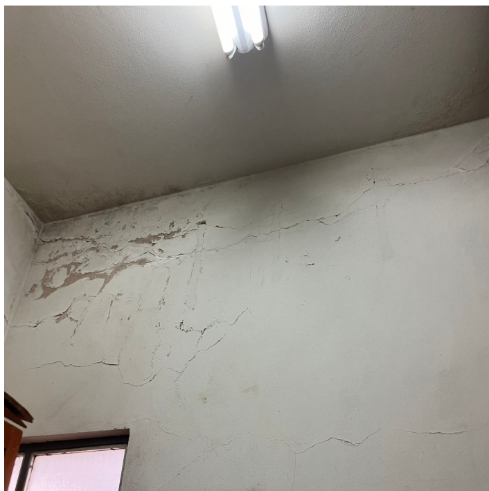
28 – Pintura Descamada na Parede – Sala.
