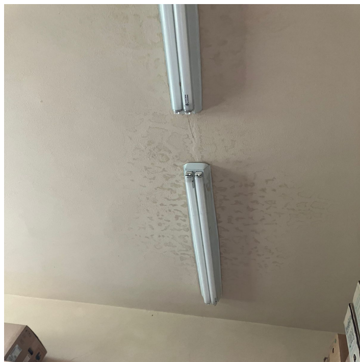
37 – Manchas de Umidade no Teto – Sala.
