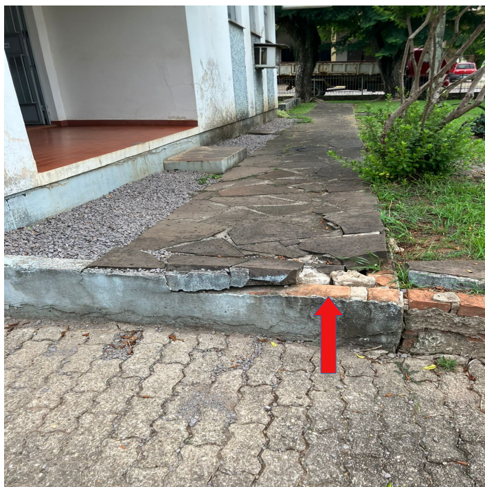
22 – Calçada em Pedras Irregulares de Basalto Solapada e Desplacada.
