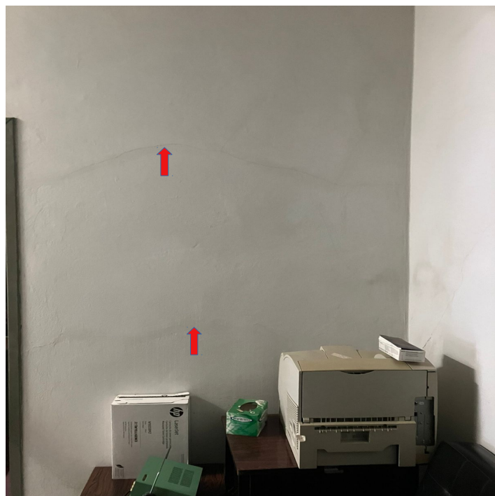
31 – Fissuras na Parede – Sala.
