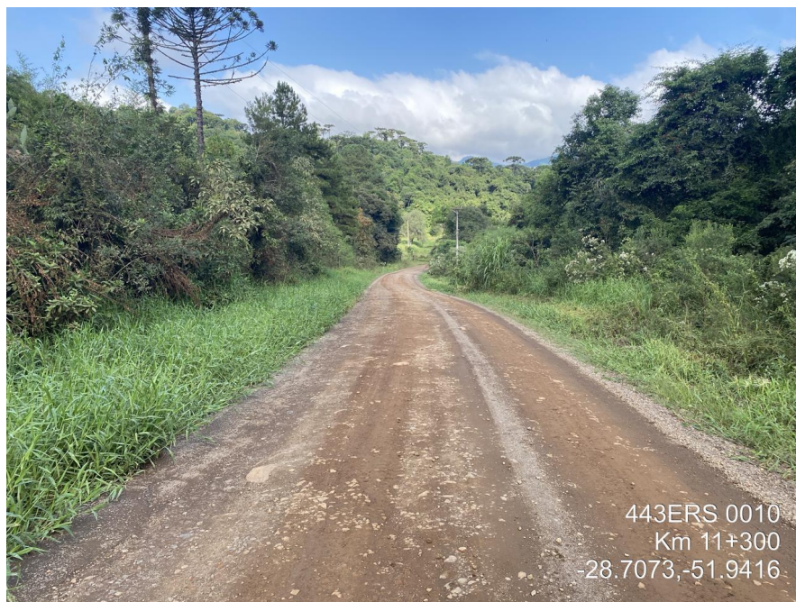
Foto 11: Situação do pavimento.
