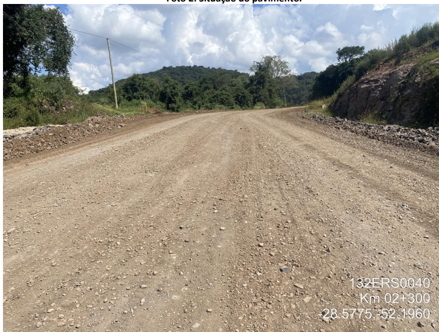
Foto 3: Situação do pavimento.
