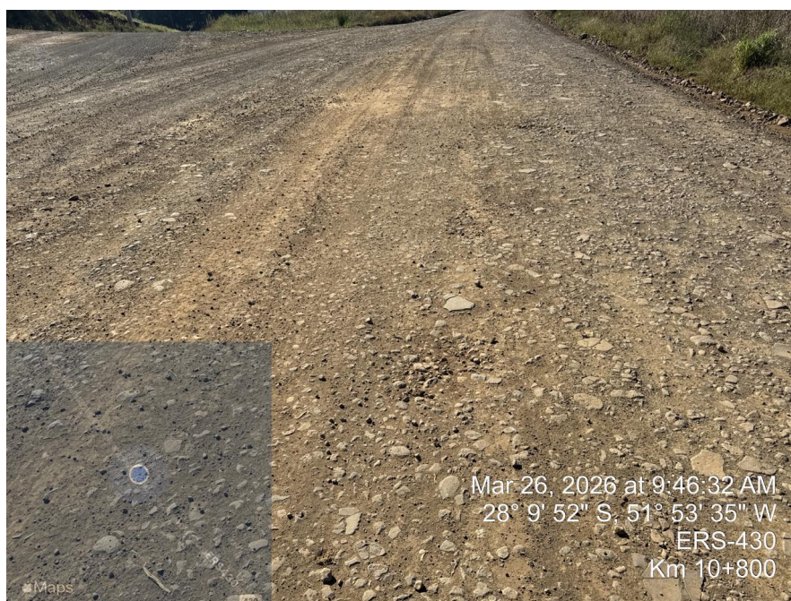
Foto 9: Situação do pavimento.
