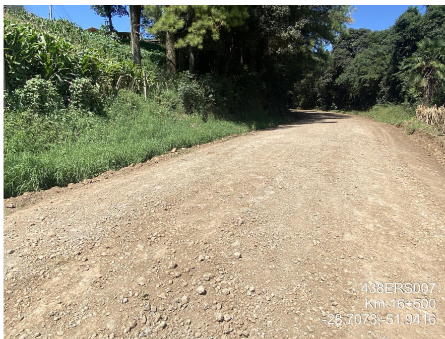
Foto 5: Situação do pavimento.
