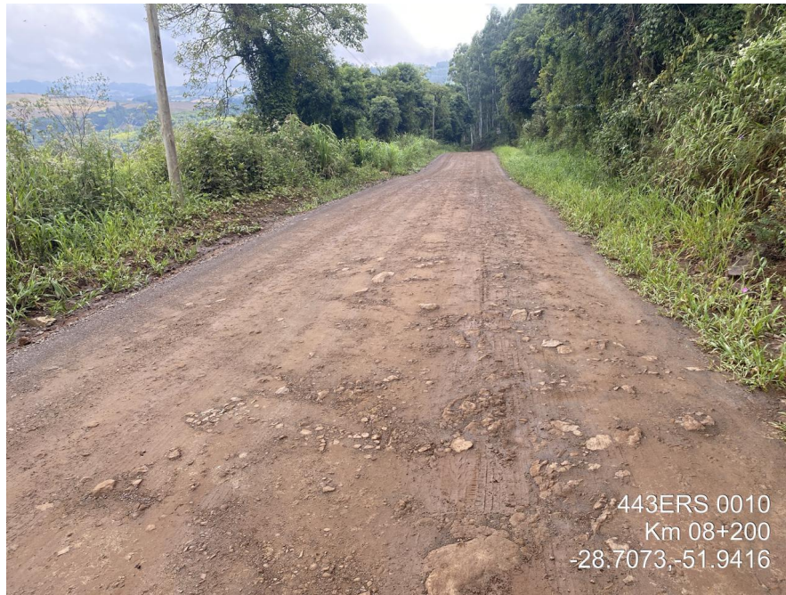
Foto 10: Situação do pavimento.
