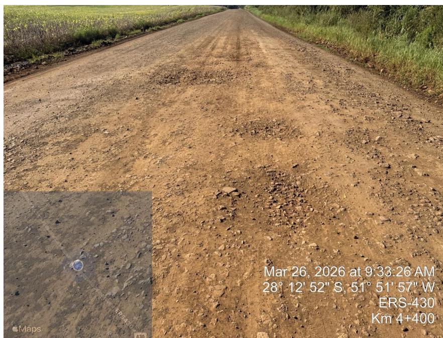
Foto 7: Situação do pavimento.
