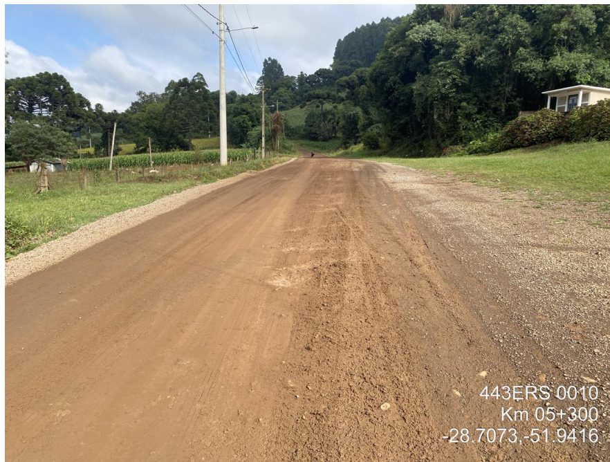
Foto 8: Situação do pavimento.
