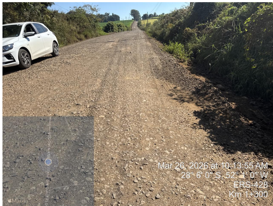
Foto 3: Situação do pavimento.
