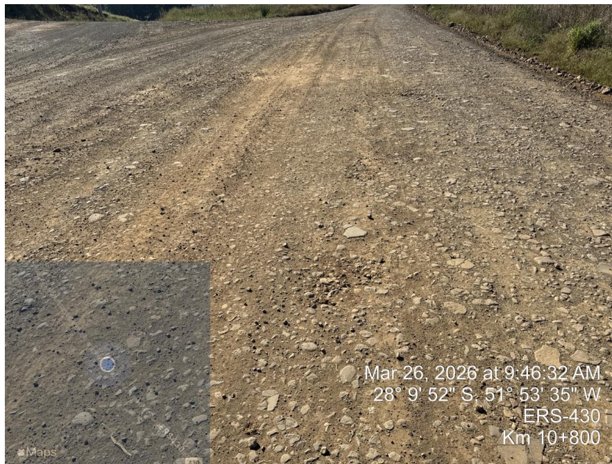
Foto 8: Situação do pavimento.
