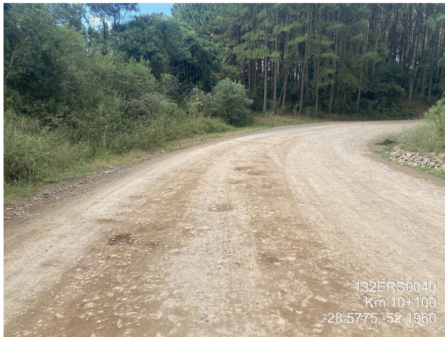
Foto 6: Situação do pavimento.
