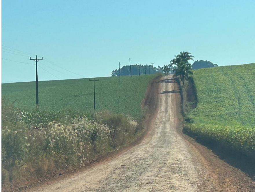
Foto 4: Situação do pavimento.
