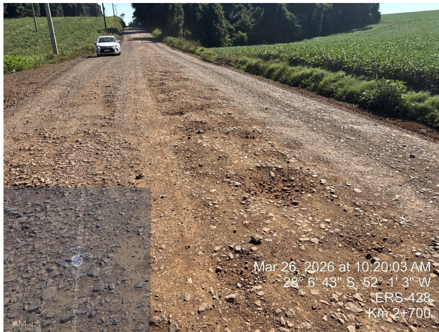
Foto 7: Situação do pavimento.
