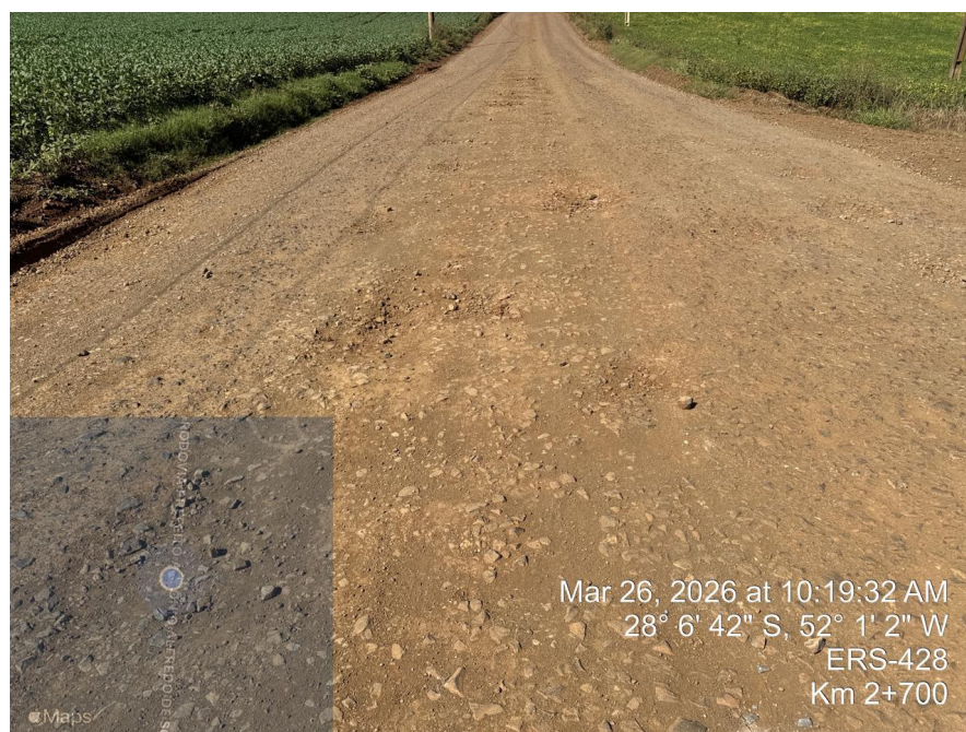
Foto 6: Situação do pavimento.
