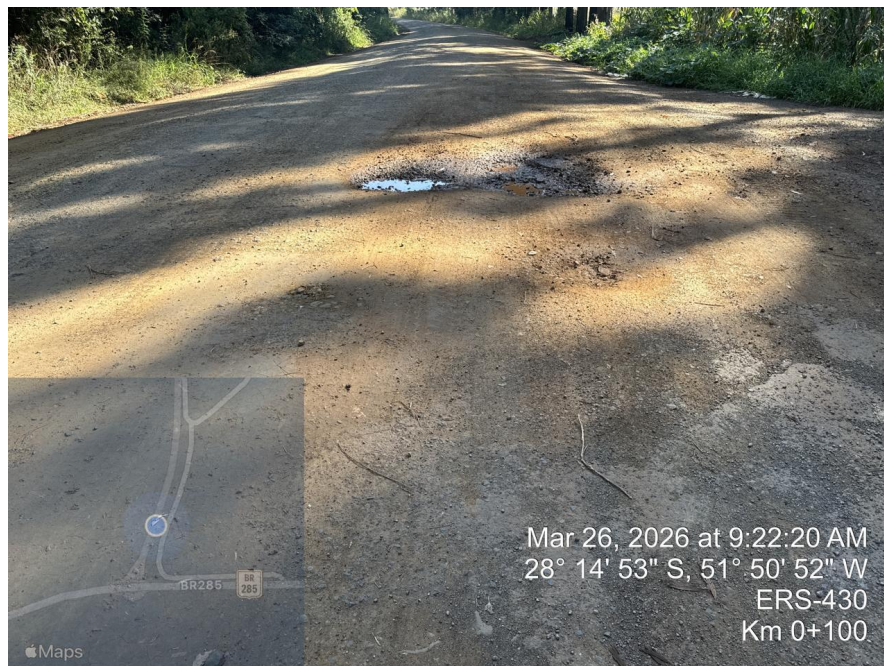
Foto 2: Situação do pavimento.
