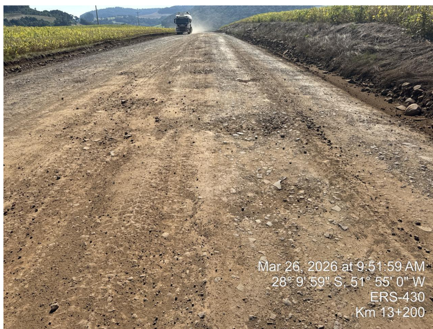
Foto 11: Situação do pavimento.
