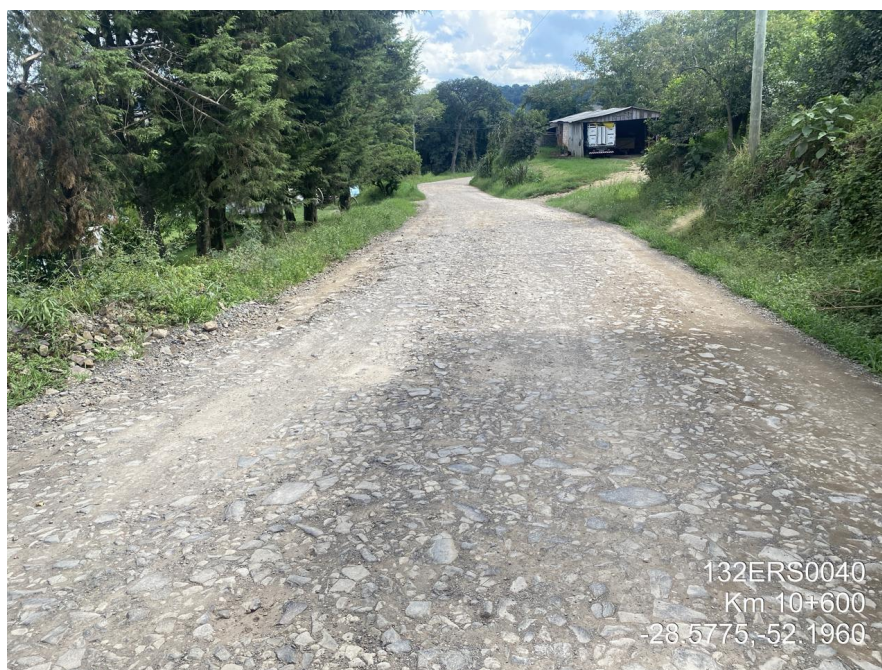
Foto 7: Situação do pavimento.
