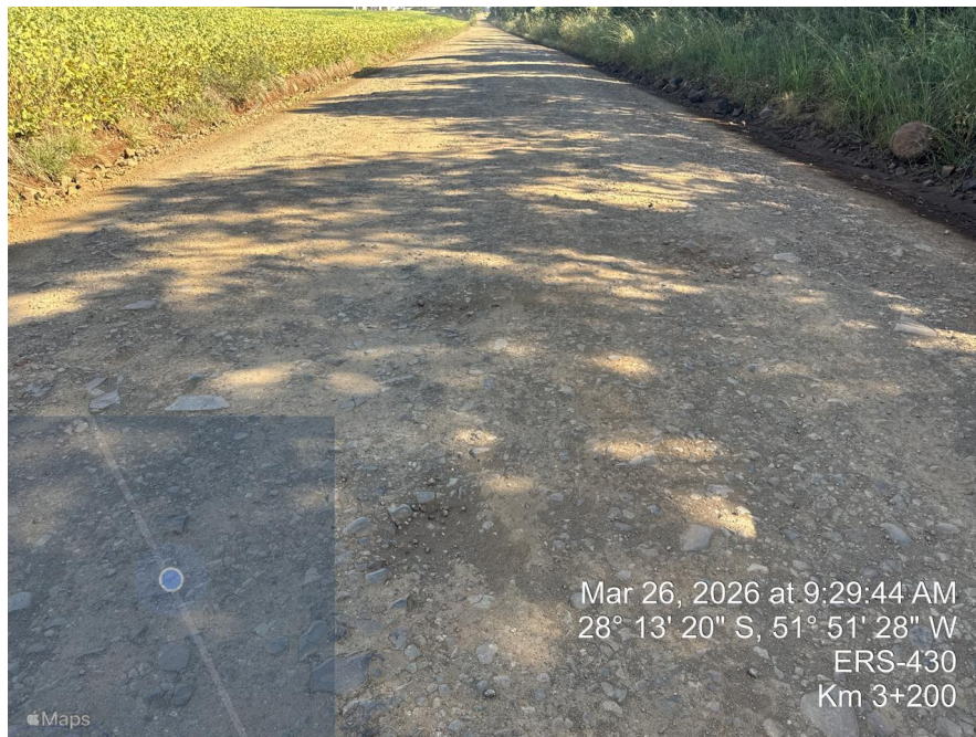
Foto 5: Situação do pavimento.
