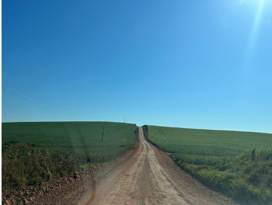
Foto 2: Situação do pavimento.
