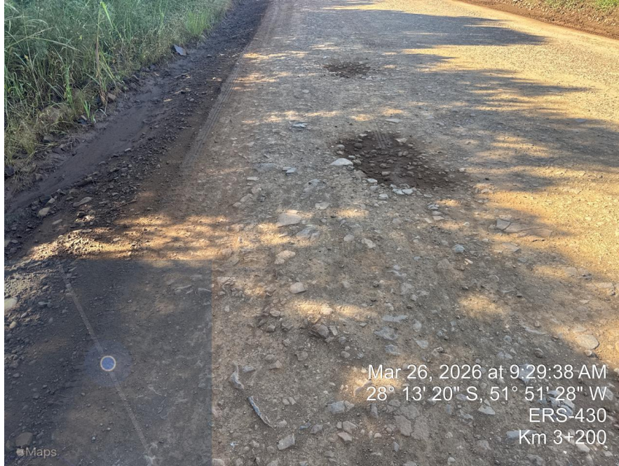
Foto 4: Situação do pavimento.
