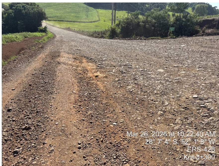
Foto 8: Situação do pavimento.
