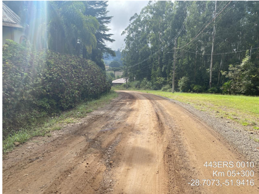
Foto 7: Situação do pavimento.
