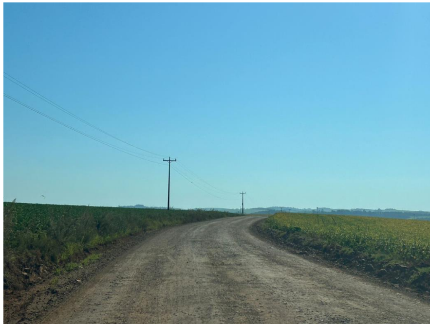
Foto 5: Situação do pavimento.
