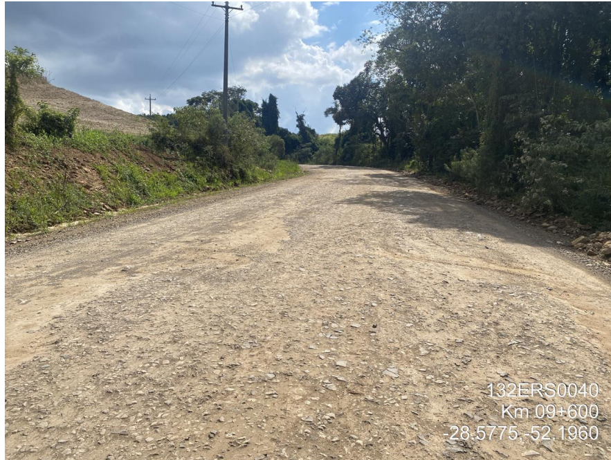
Foto 5: Situação do pavimento.
