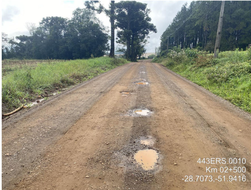
Foto 6: Situação do pavimento.
