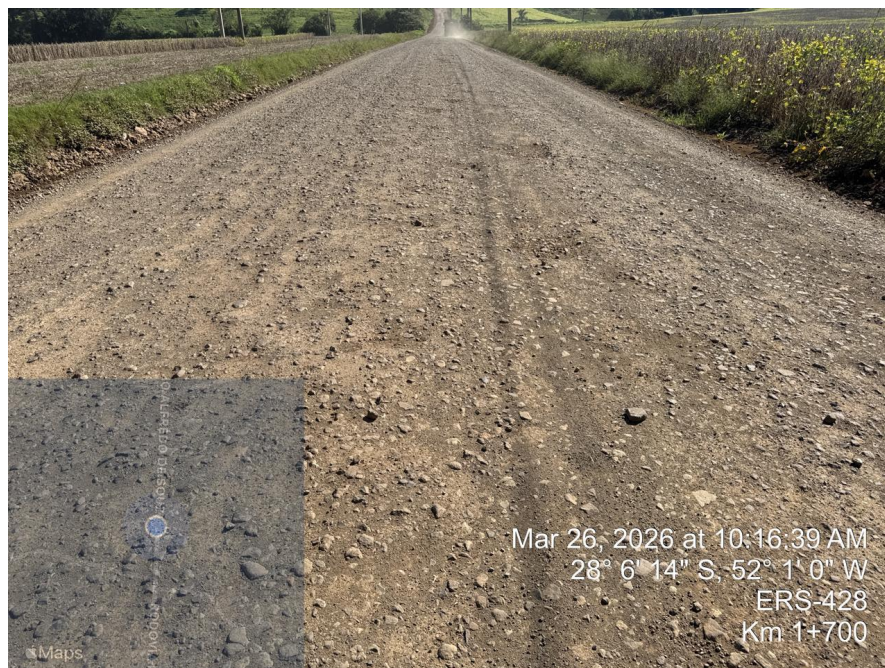
Foto 5: Situação do pavimento.
