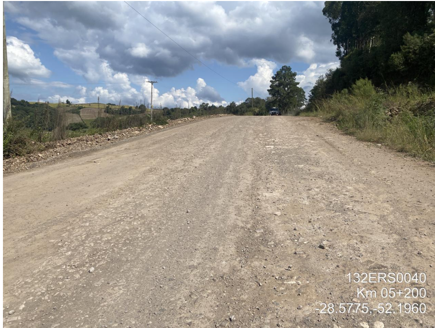
Foto 4: Situação do pavimento.
