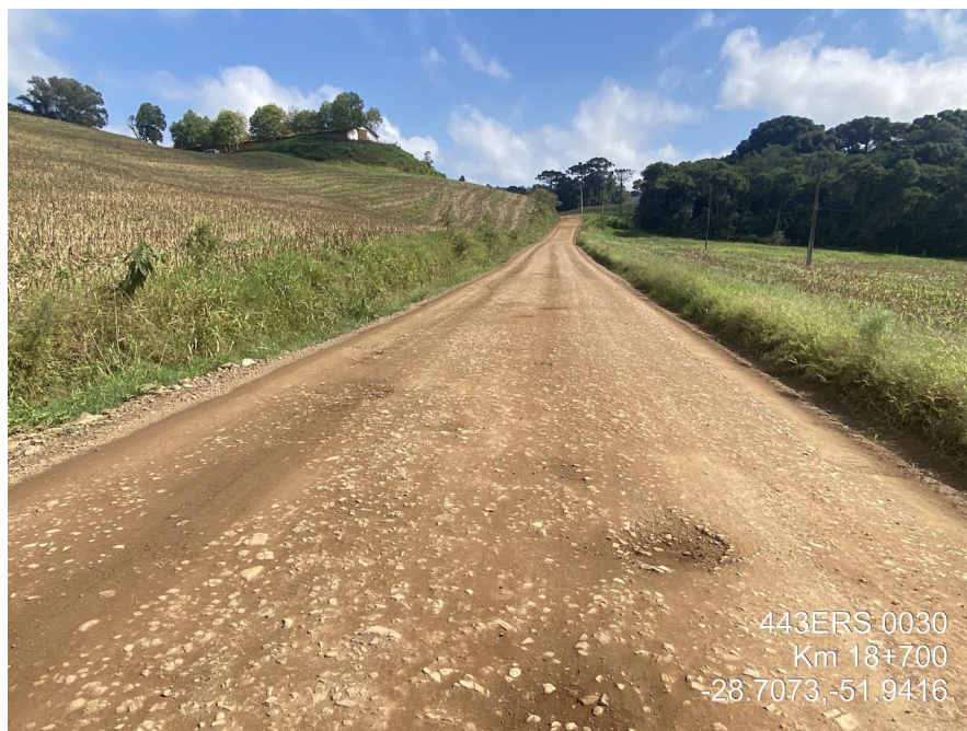
Foto 13: Situação do pavimento.
