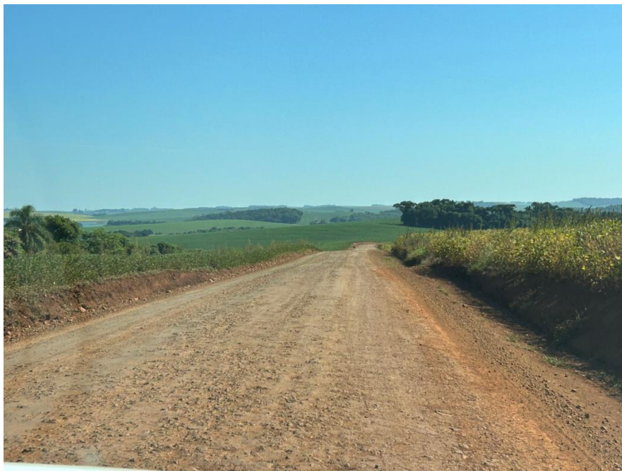
Foto 3: Situação do pavimento.
