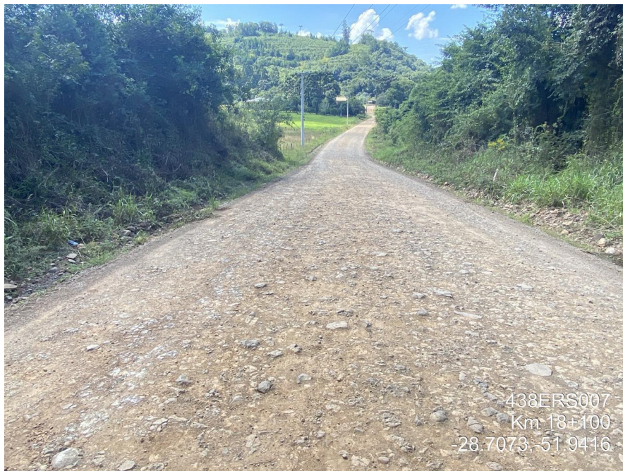
Foto 6: Situação do pavimento.
