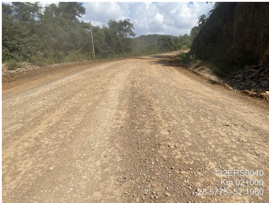
Foto 2: Situação do pavimento.
