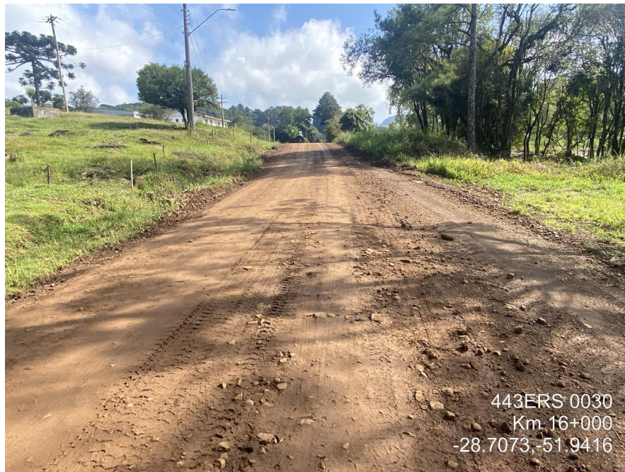
Foto 12: Situação do pavimento.
