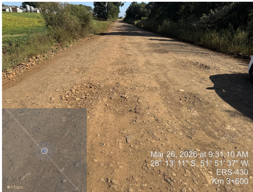
Foto 6: Situação do pavimento.
