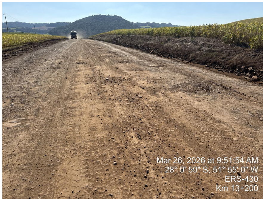
Foto 10: Situação do pavimento.
