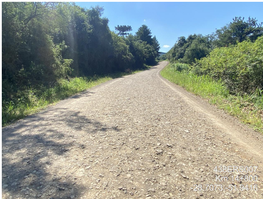
Foto 4: Situação do pavimento.
