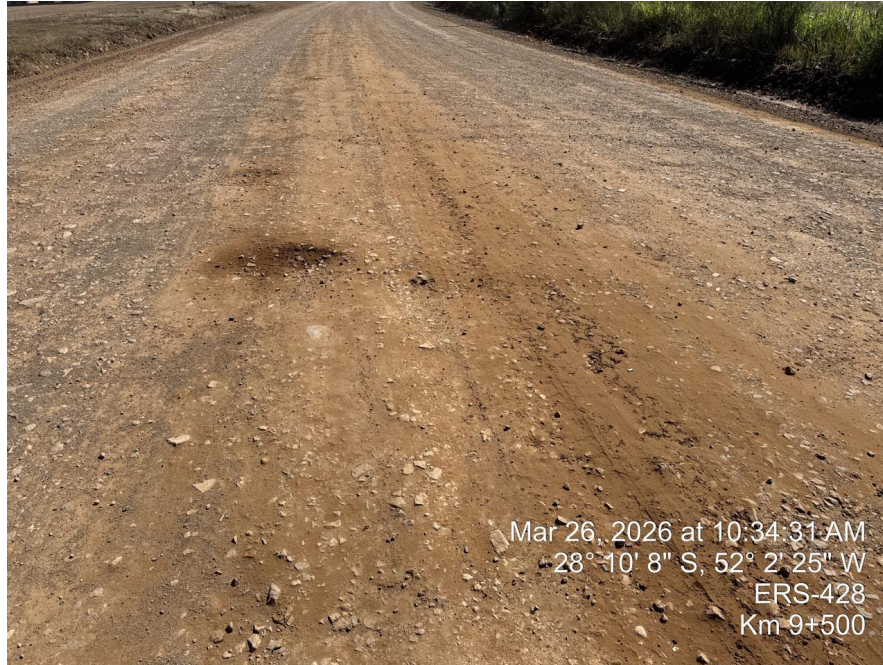
Foto 9: Situação do pavimento.
