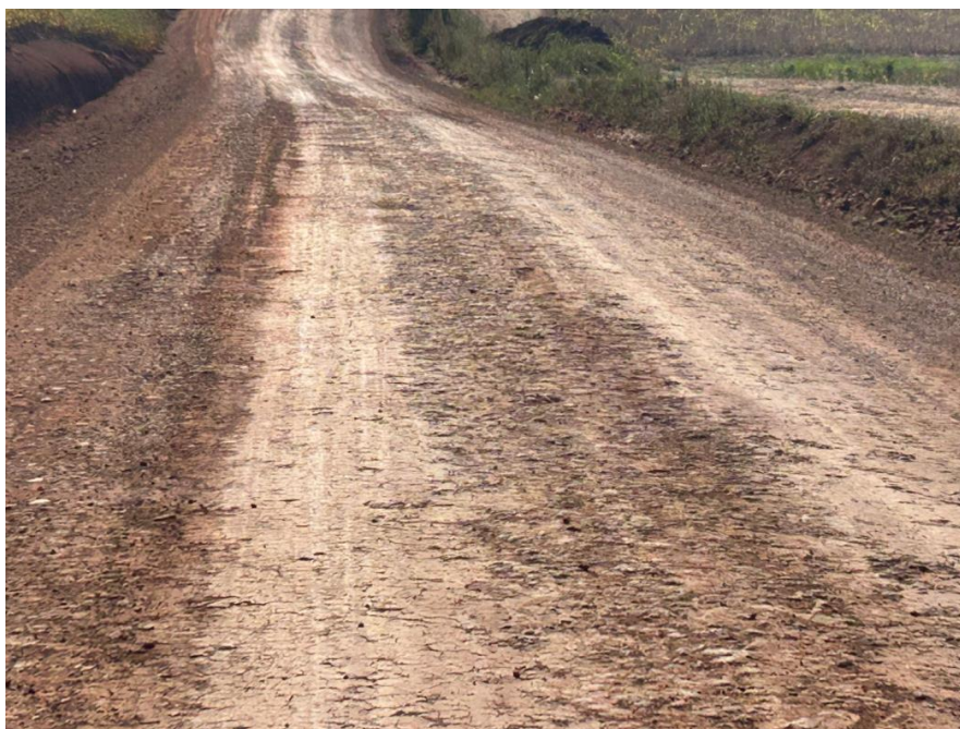
Foto 7: Situação do pavimento.
