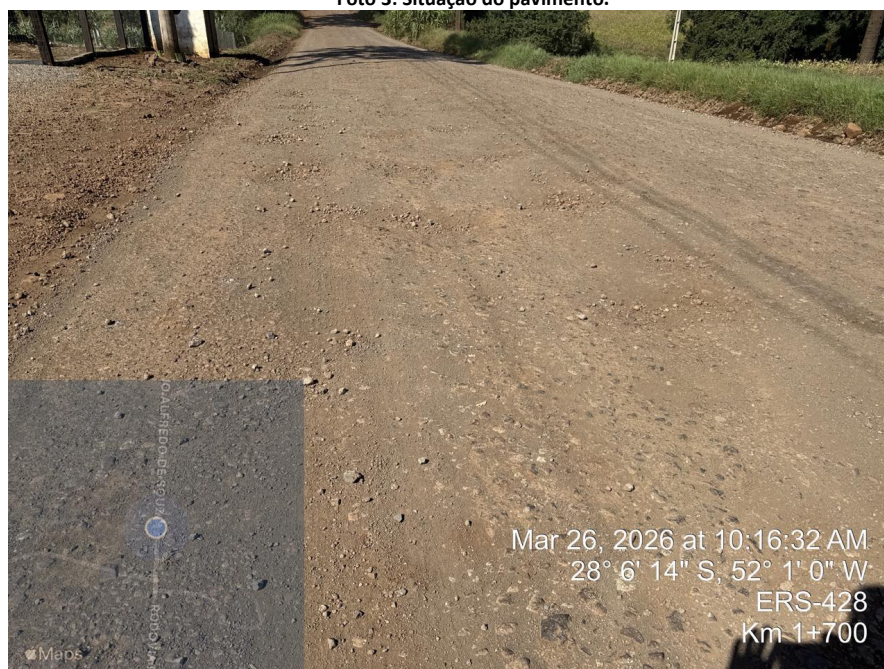
Foto 4: Situação do pavimento.
