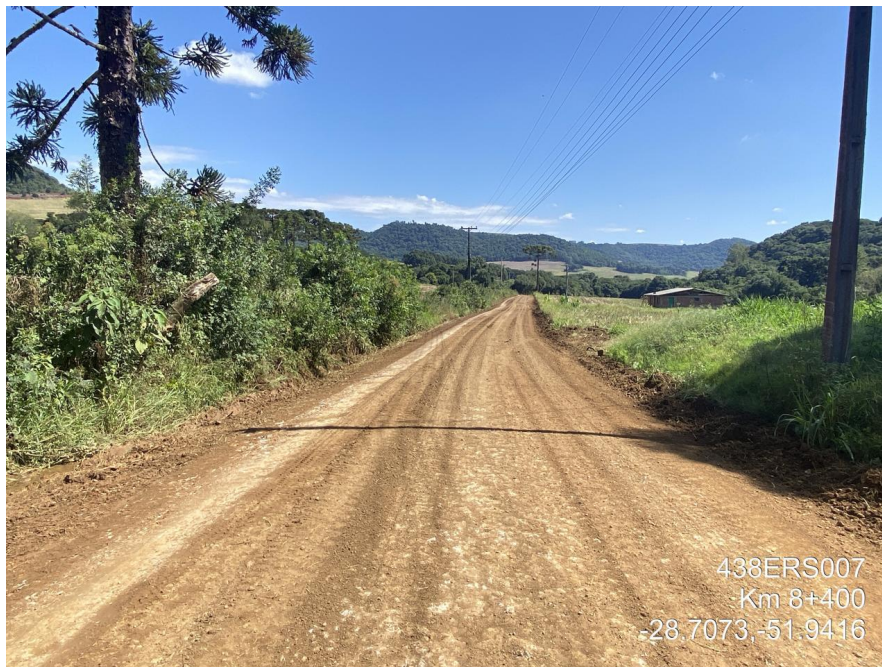
Foto 2: Situação do pavimento.
