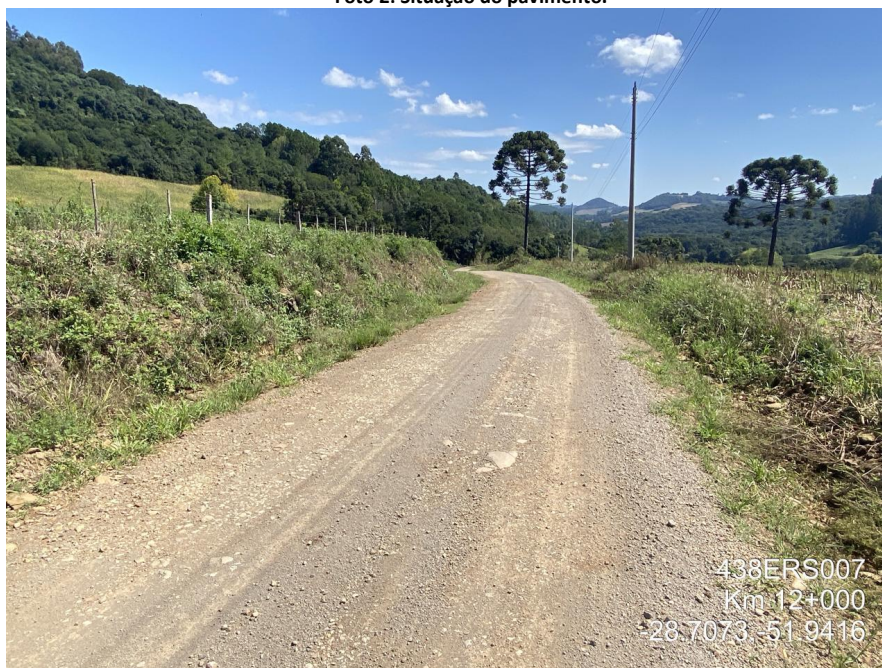
Foto 3: Situação do pavimento.
