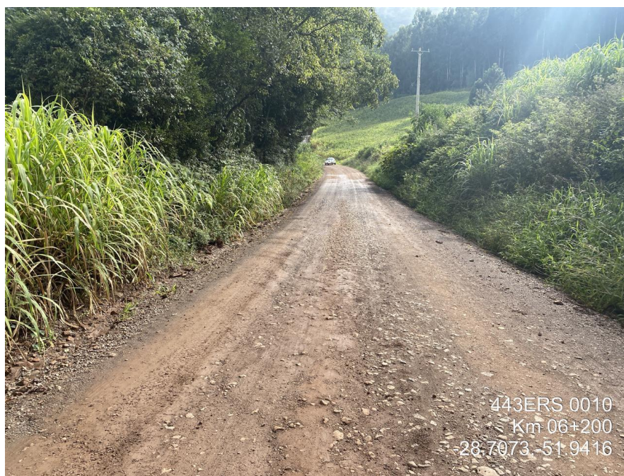
Foto 9: Situação do pavimento.
