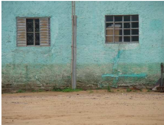
Marcas de enchente na construção
