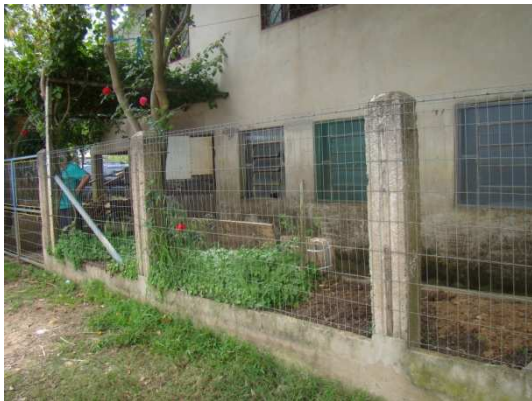
Marcas da enchente na parede de casa próxima ao Rio Caí. De acordo com o morador da casa (Sr. Claudio) a água praticamente encobriu as janelas na enchente de agosto de 2013.
