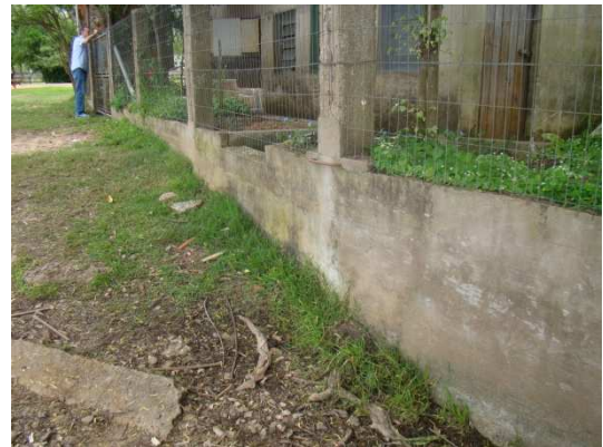
Marcas da enchente no muro próxima ao Rio Caí. O morador relatou que o nível do rio Caí sobe não apenas quando ocorrem precipitações intensas, mas também com a ação do vento sul. Relatando assim os efeitos do remanso do rio Caí
