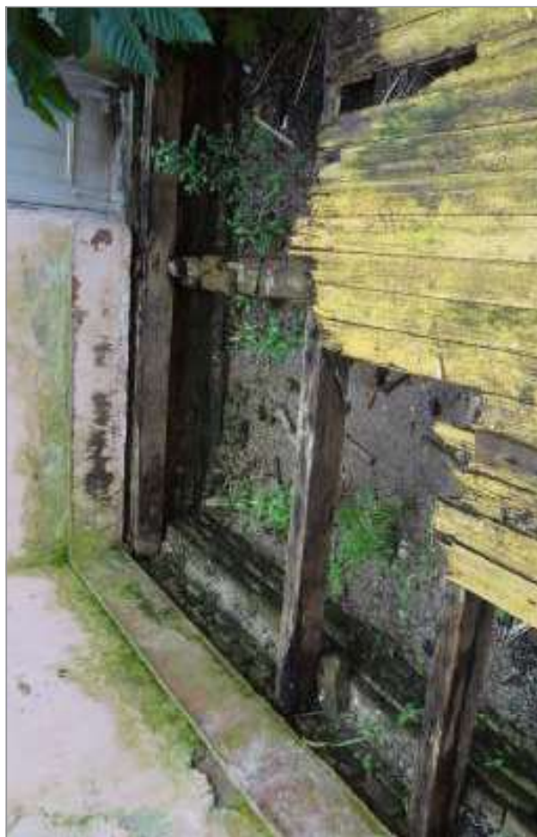
foto 93/168 - Detalhe do arruinamento do piso do Ambiente 03.
