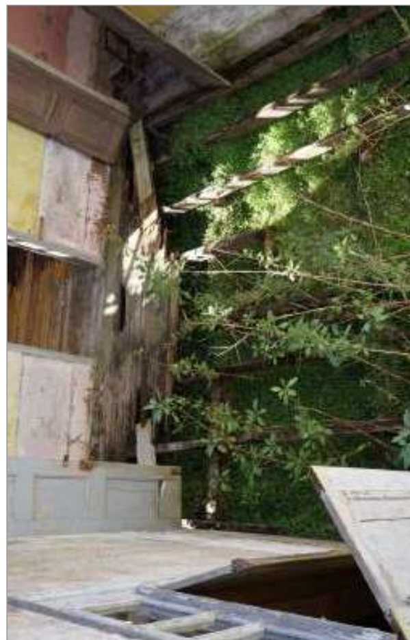
foto 102/168 - Vista superior do arruinamento do piso no Ambiente 04.
