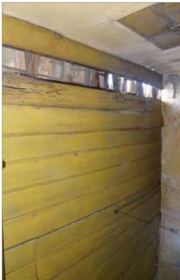
foto 142/168 - Forro da cozinha.
