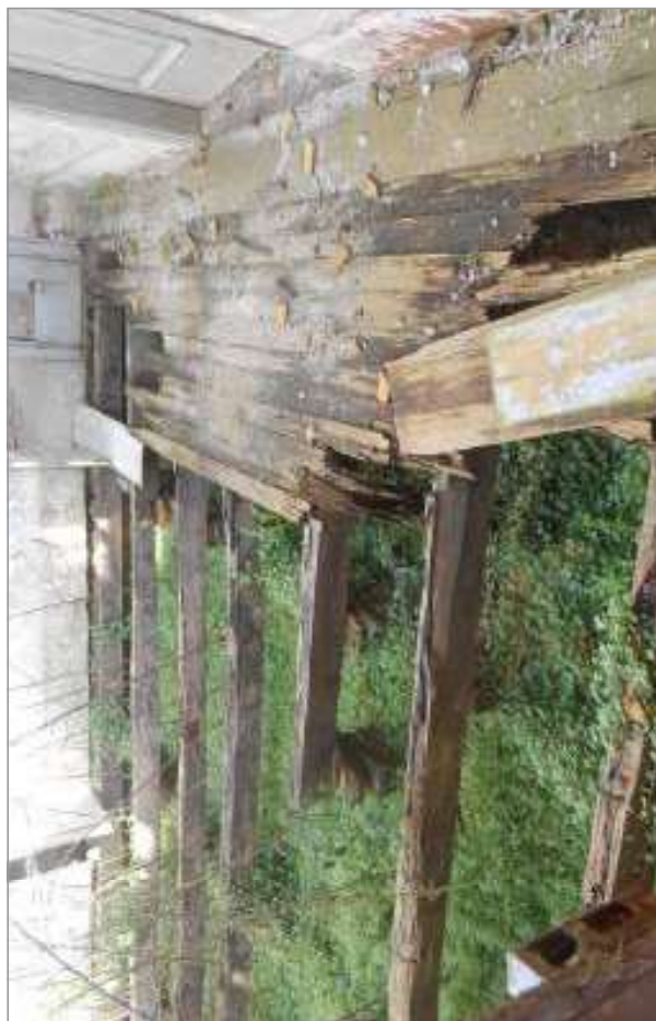
foto 101/168 - Arruinamento do piso do Ambiente 04.
