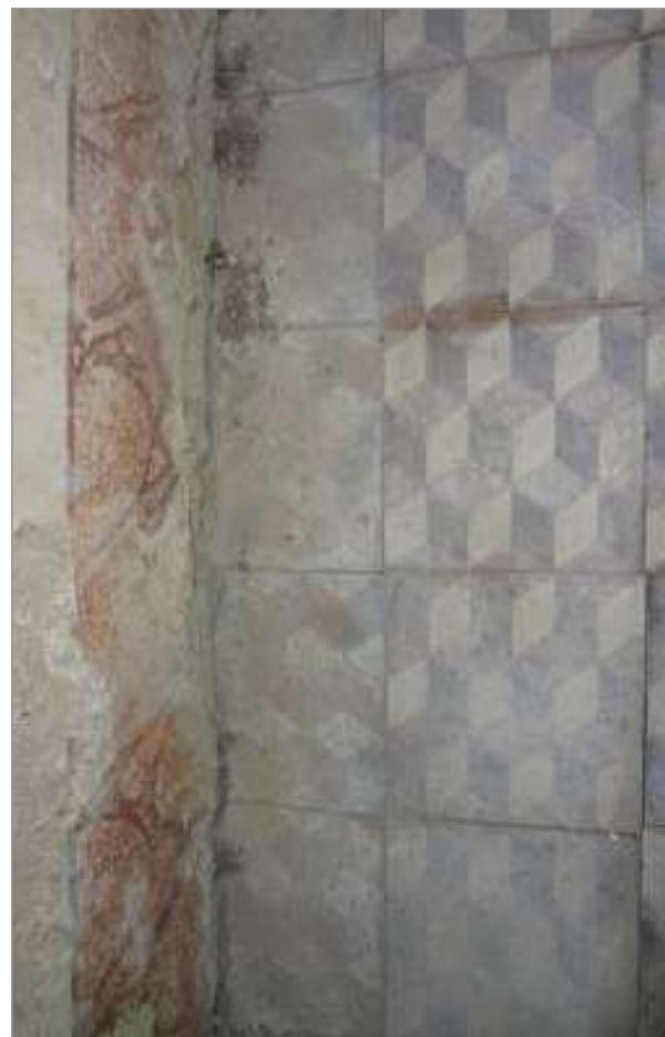
foto 145/168 - Detalhe da escaiola no rodapé da cozinha.
