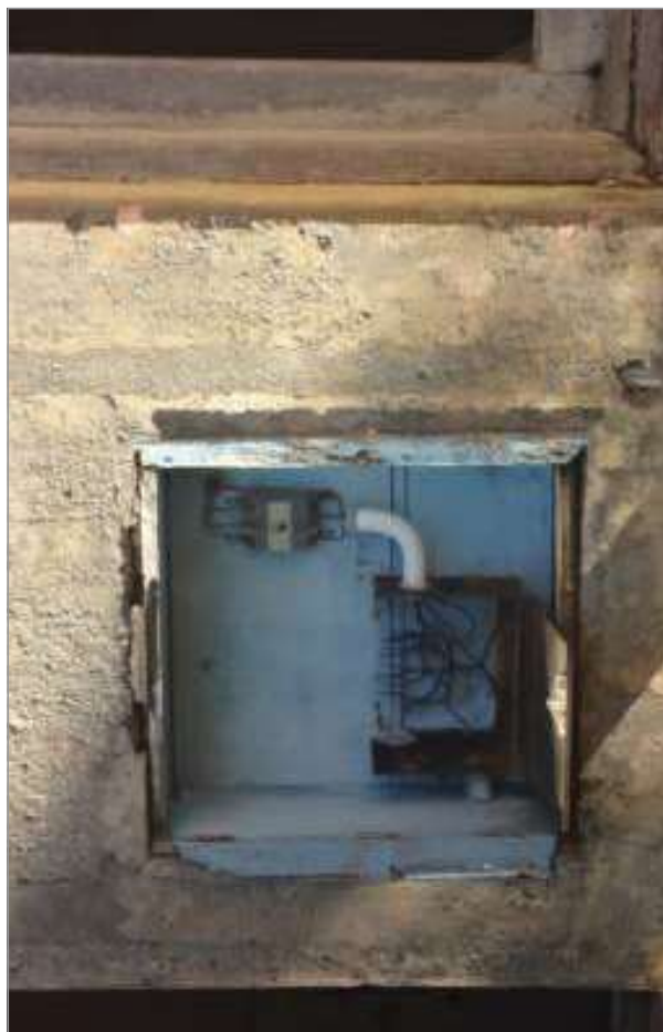
foto 167/168 - Detalhe entrada de energia.
