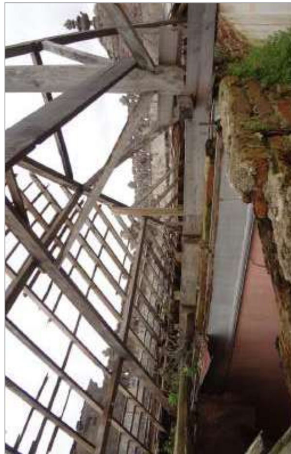
foto 46/168 - Estrutura de telhado restante.
