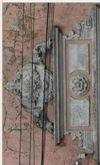
figura 08 – ornato em massa a ser restaurado
