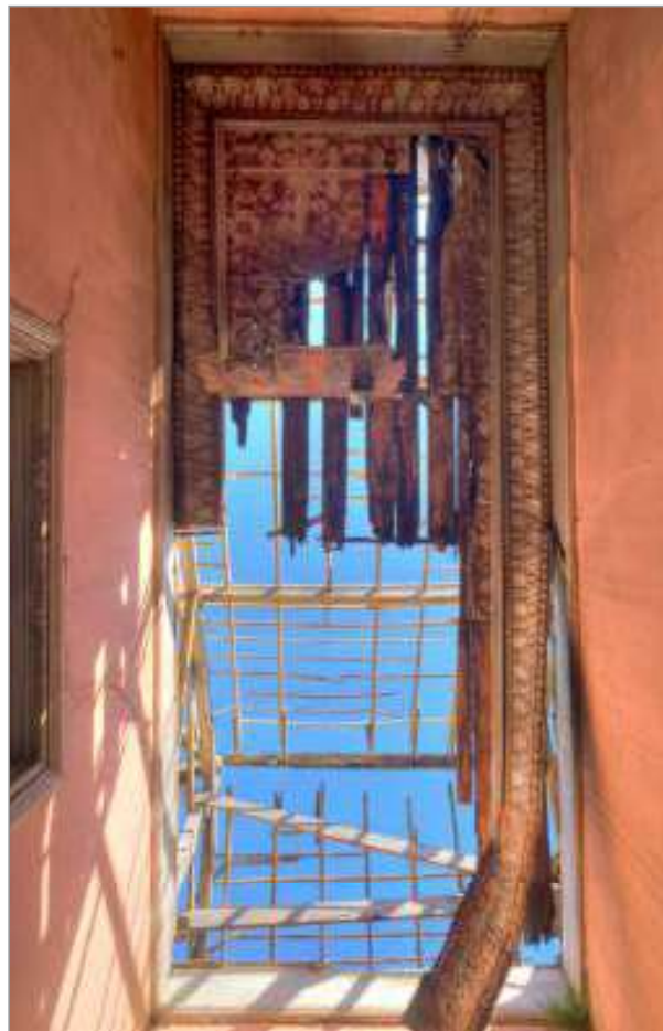
foto 56/168 - Forro em arruinamento sobre o Hall.
