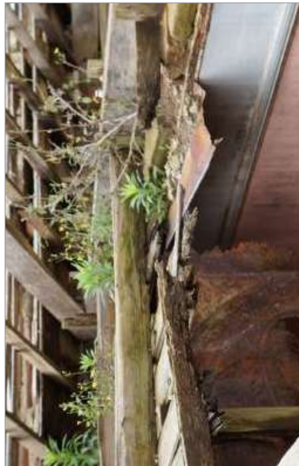
foto 40/168 - Detalhe do forro em arruinamento sobre o antigo Hall.
