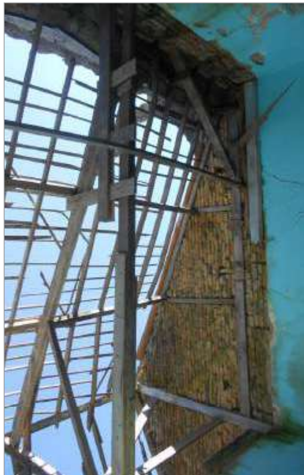
foto 79/168 - Estrutura de telhado remanescente sobre o Ambiente 02.
