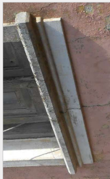
figura 11 – peitoril em massa a ser restaurado
