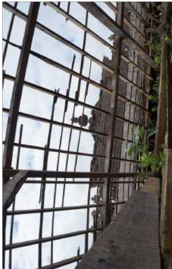
foto 44/168 - Detalhe da estrutura de telhado em arruinamento.
