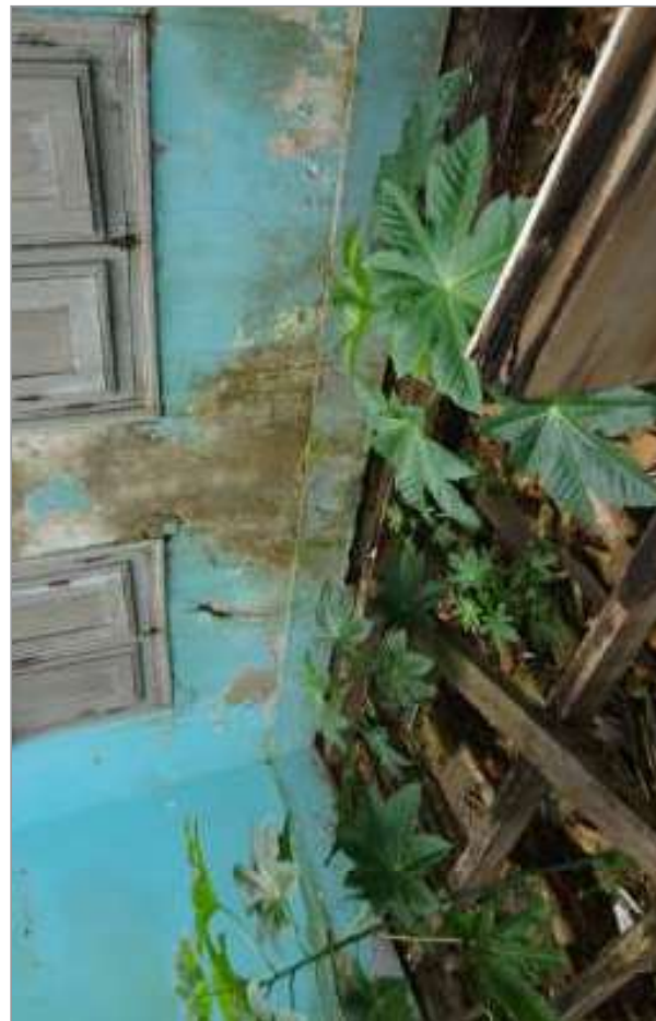
foto 81/168 - Deterioração do piso no Ambiente 02.
