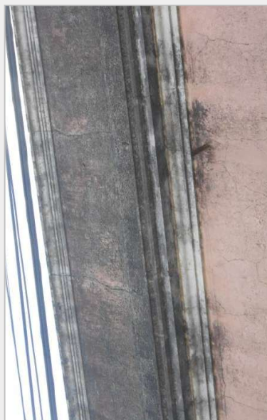
figura 07 – cimalkhas em massa a serem restauradas
