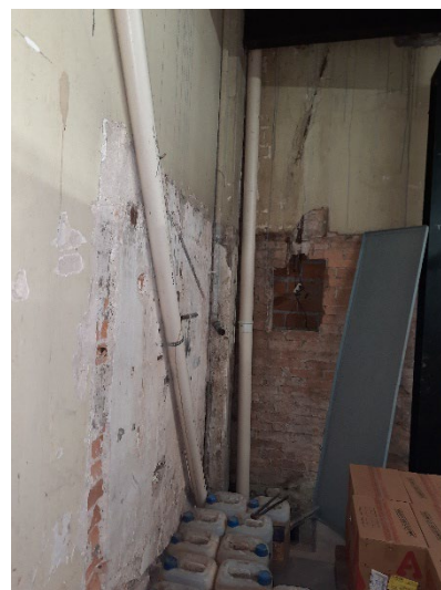
Figura 14 Parede em péssimo estado.
