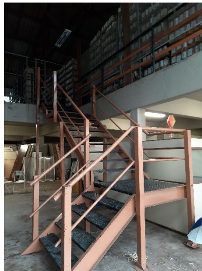
Figura 30 Escada de acesso muito frágil.
