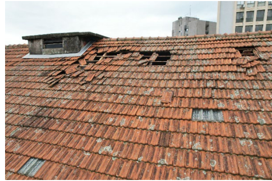
Figura 46 Lacunas que comprometem a conservação de todo o edifício.
