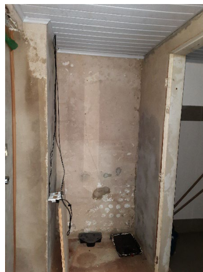
Figura 8 Espaço de sanitários inacabado.
