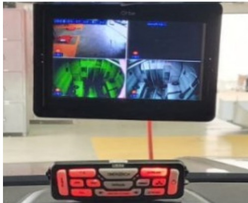
Fig. 9- Vista do sistema de vídeo monitoramento
