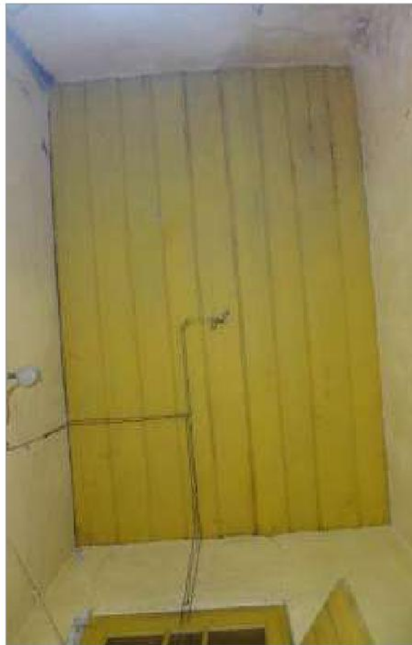
foto 132/168 - Forro do banheiro.
