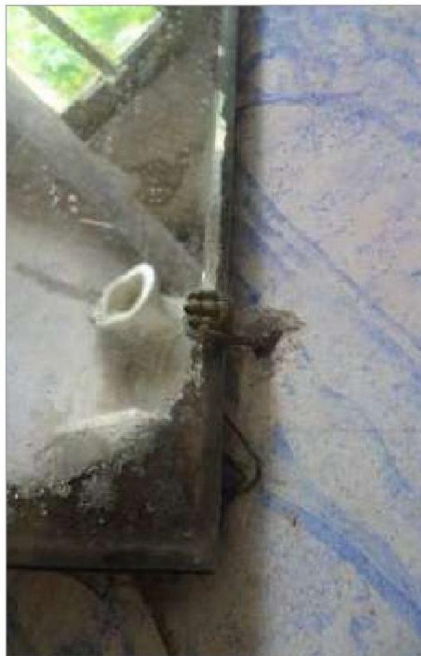
foto 134/168 - Detalhe da presilha do vidro do espelho do banheiro.
