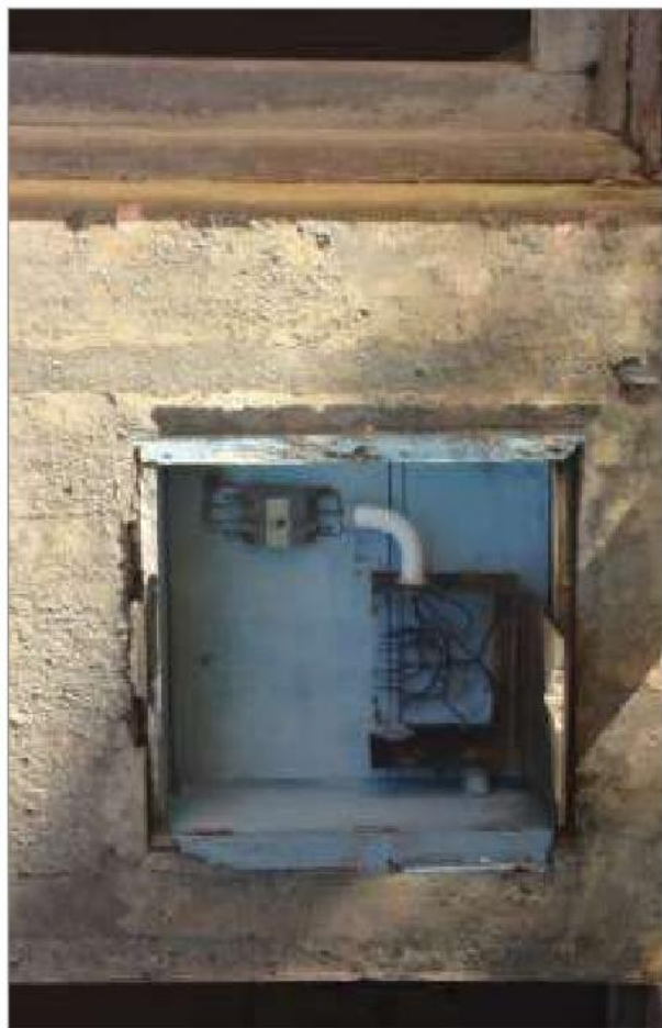
foto 167/168 - Detalhe entrada de energia.
