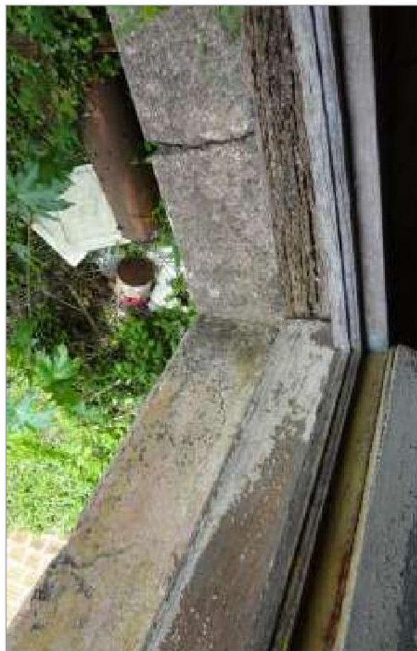
foto 143/168 - Parapeito da janela da cozinha.
