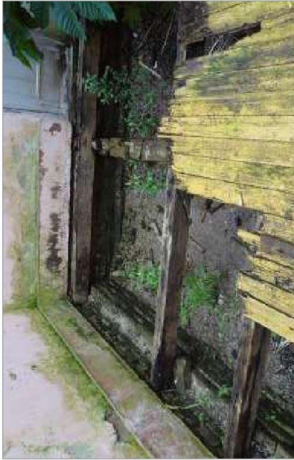
foto 93/168 - Detalhe do arruinamento do piso do Ambiente 03.
