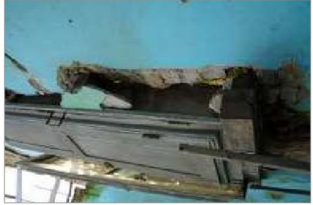
foto 86/168 - Detalhe de esquadria do Ambiente 02.
