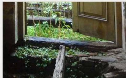
figura 29 – soleira em madeira a ser restaurada
