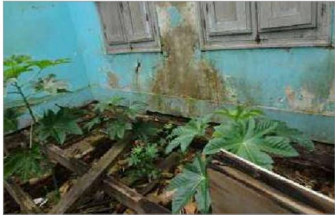
foto 81/168 - Deterioração do piso no Ambiente 02.
