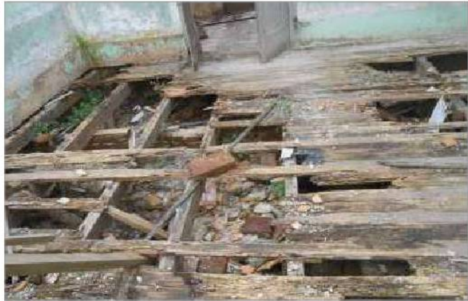
foto73/168 - Outra vista do piso em arruinação do Ambiente 01.
