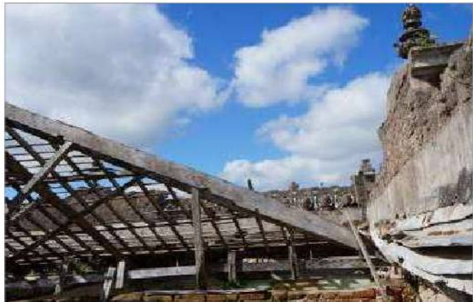
foto 22/168 - Telhado em arruinação.
