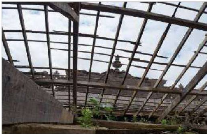
foto 44/168 - Detalhe da estrutura de telhado em arruinamento.
