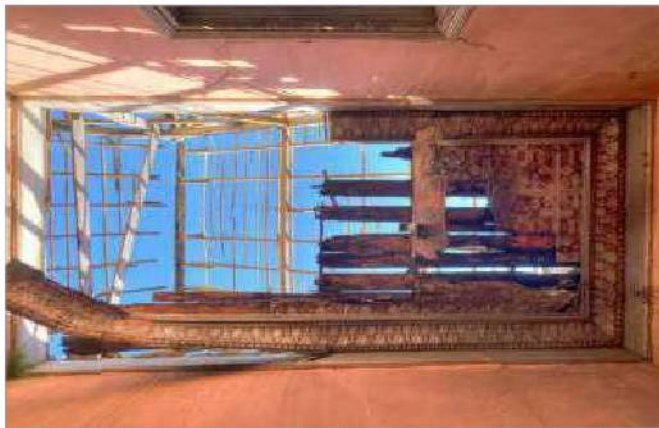
foto 56/168 - Forro em arruinamento sobre o Hall.
