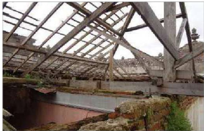
foto 46/168 - Estrutura de telhado restante.
