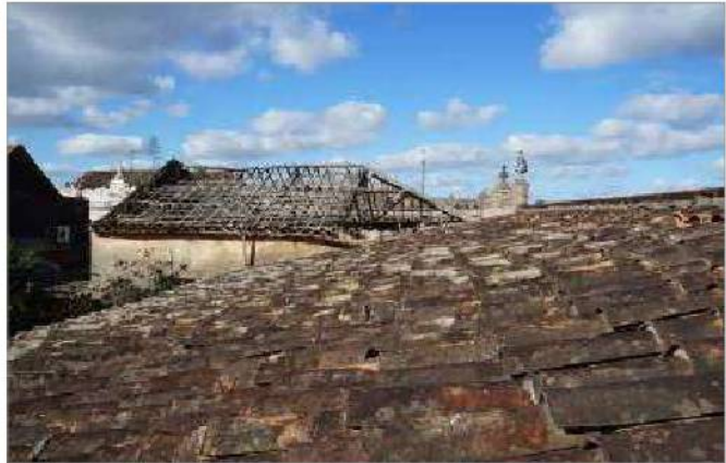
foto 25/168 - Telhado em arruinação visto desde o telhado do volume posterior.
