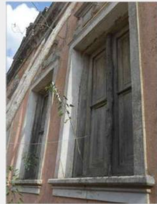
figura 09 – golas das janelas em massa a serem restauradas
