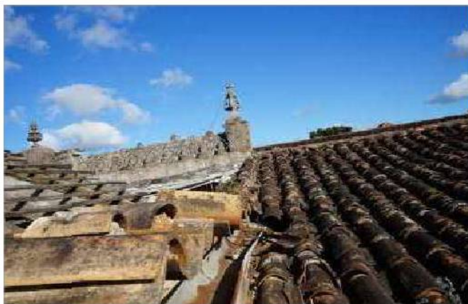
foto 29/168 - Vista dos telhados desde o interior em direção à Rua Andrade Neves.
