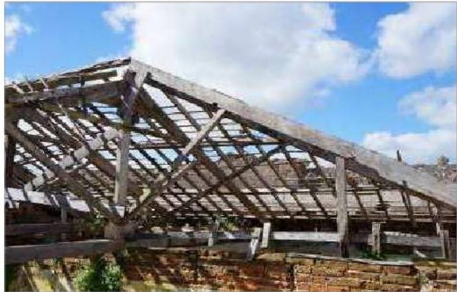
foto 23/168 - Telhado em arruinação. Pendural.
