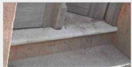
figura 27 – soleira hall de entrada em mármore a ser restaurada
