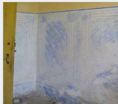
figura 13 – paredes do banheiro em escaiola a ser restaurada
