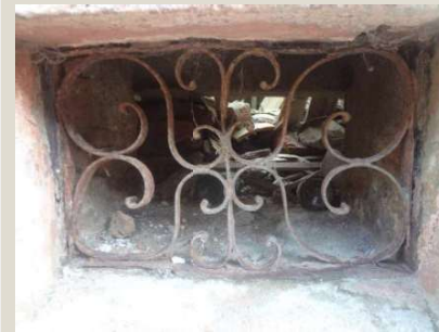
Figura 08 – Foto da gradeira existente no prédio Fonte: Foto equipe SNA
