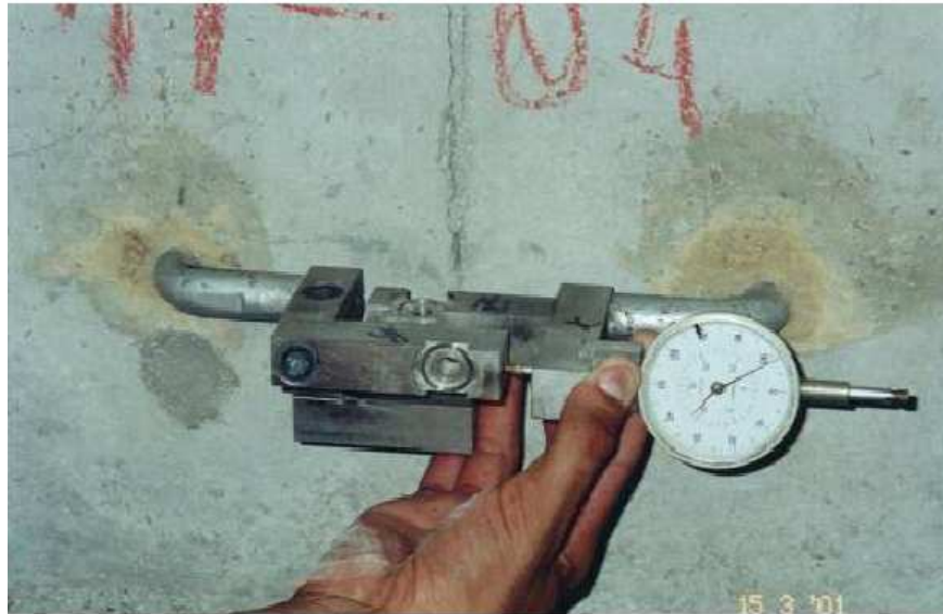
Figura 11.2: Foto de um medidor triortogonal mecânico instalado
