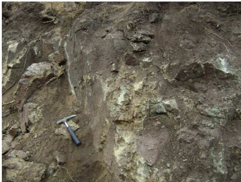
Figura 3.25: Falha localizada na base da encosta – ombreira esquerda
