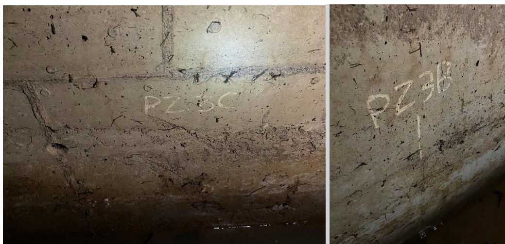
Figura 55 – Posição de um conjunto de piezômetro na galeria.
