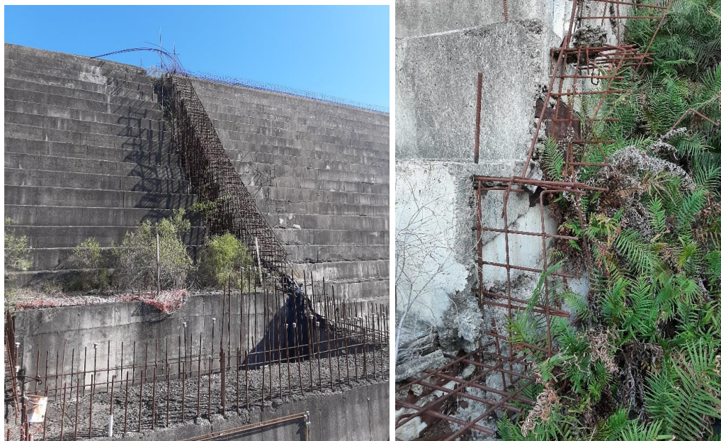
Figura 42 – armaduras de espera e de montagem expostas às intemperes desde a paralização das obras por volta de 2011.
