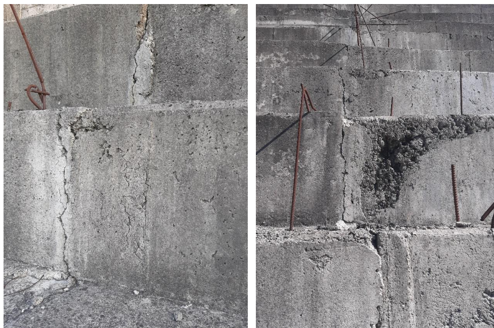
Figura 43 – patologias no concreto de jusante. Trincas desgaseamento, respectivamente.
