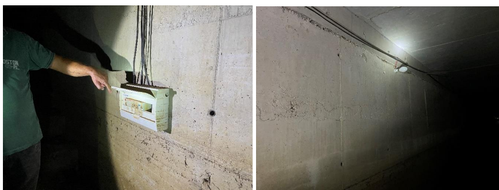
Figura 18 – sistema de iluminação provisória desativado.
