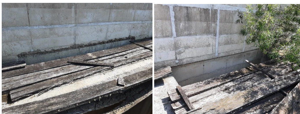
Figura 35 – desalinhamento da concretagem acima da estrutura das comportas da adufa.
