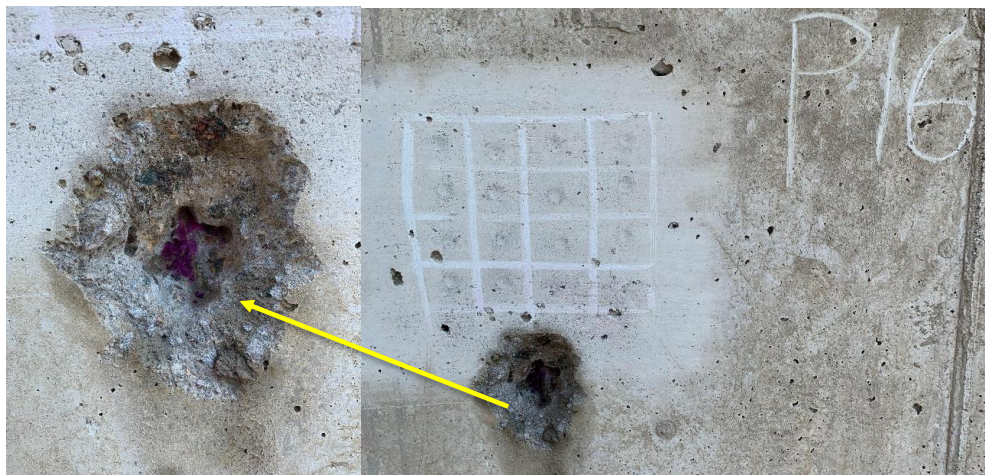
Figura 54 – Exemplo de ensaio de profundidade de carbonatação.
