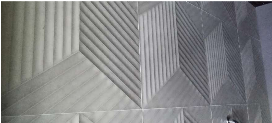
Na imagem acima, trecho da parede com Revestimento Cerâmico Tipo 3D já aplicado no 2º Pavimento do Edifício-Sede nos WCs Centrais.
