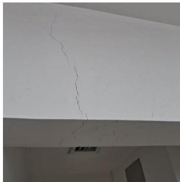
Imagem 134 - Parede com trinca
