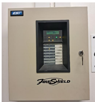
Imagem 19 - Sistema de alarme Fire Shield EST
