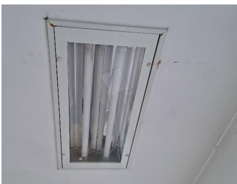
Imagem 9 - Luminária fluorescente danificada - NB2
