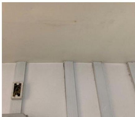
Imagem 13 - Manchas no forro por umidade - NB2
