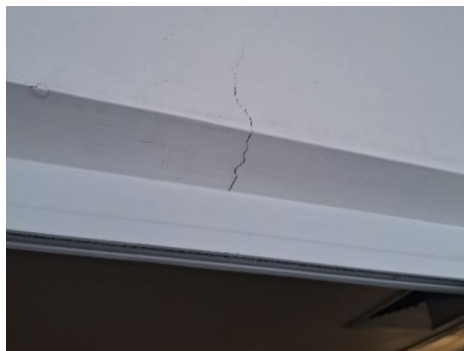
Imagem 26 - Parede trincada sala eclusa
