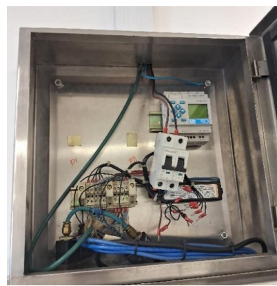
Imagem 16 - Quadro elétrico do Passthrough danificado
