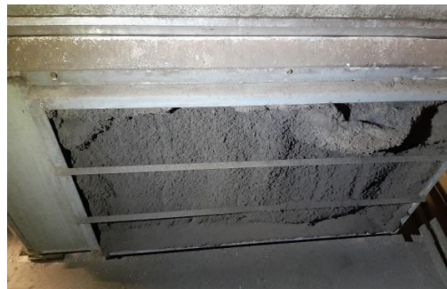
Imagem 110 - Filtros do Fan Coil saturado
