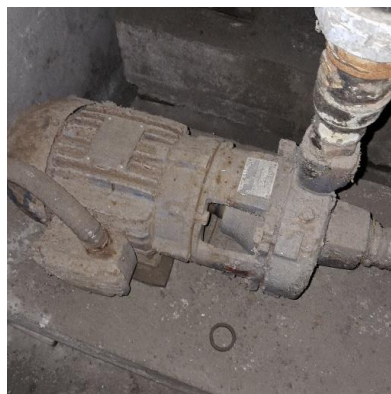
Imagem 80 - Bomba de água gelada (AG)
