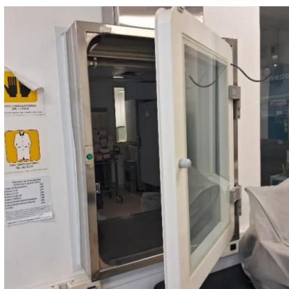
Imagem 15 - Passthrough sem vedação e inoperante
