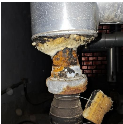
Imagem 83 - Tubulação de AG com oxidação
