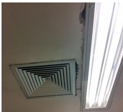
Imagem 34 - Forro danificado - NB3
