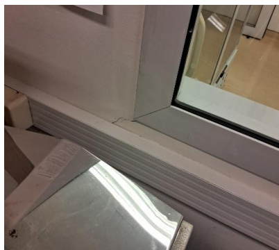
Imagem 38 - Parede trincada - NB3
