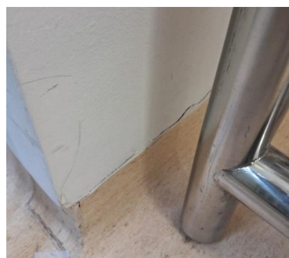
Imagem 43 - Rodapé danificado - NB3
