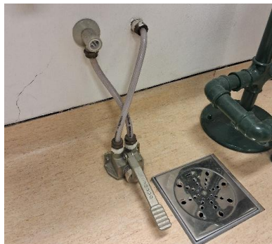
Imagem 12 - Acionamento ineficiente da torneira
