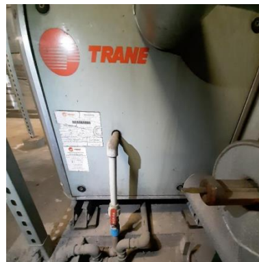
Imagem 112 - Sistema de drenagem do Fan Coil
