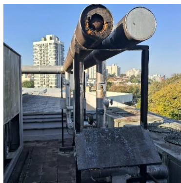
Imagem 59 - Sistema de água gelada inoperante
