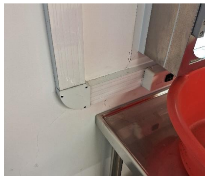
Imagem 39 - Parede trincada - NB3
