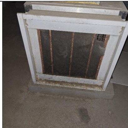
Imagem 98 - Ventilador OTAM danificado
