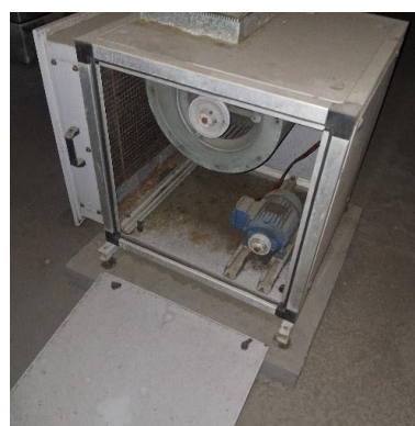
Imagem 96 - Ventilador OTAM danificado
