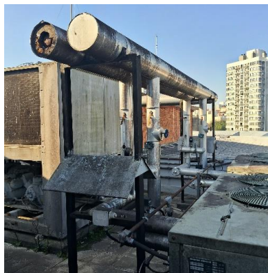
Imagem 57 - Sistema de água gelada sucateado
