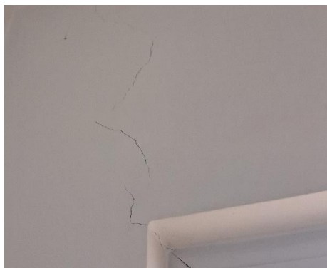
Imagem 5 - Parede trincada - NB2
