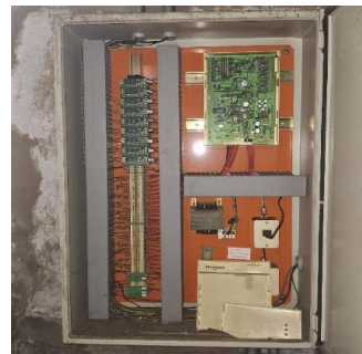
Imagem 136 - Quadro de comando atual
