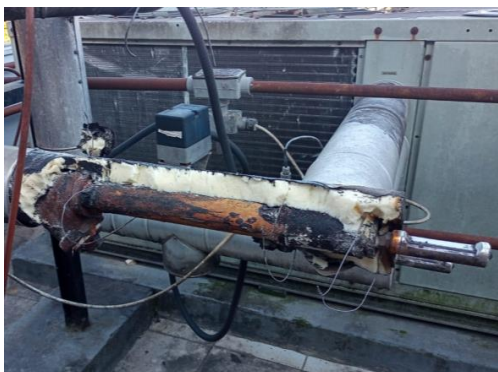
Imagem 62 - Tubulação de água com muita oxidação
