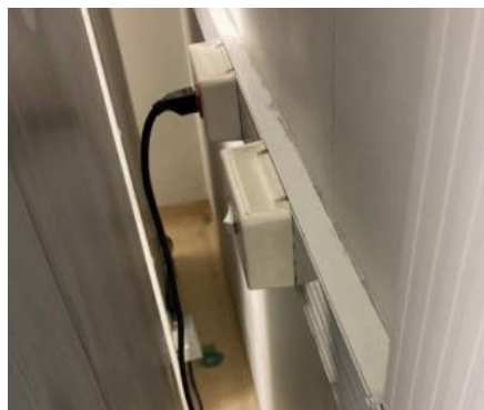
Imagem 17 - Interruptor atrás de equipamentos
