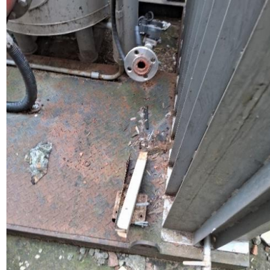
Imagem 128 - Falta de bomba
