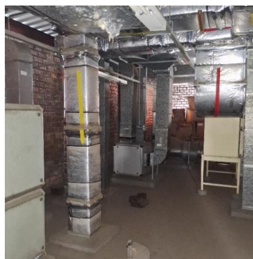
Imagem 106 - Equipamentos e dutos
