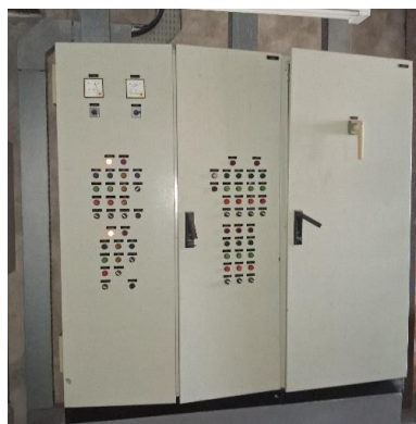
Imagem 92 - Quadro de energia
