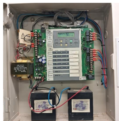
Imagem 20 - Sistema de alarme Fire Shield EST
