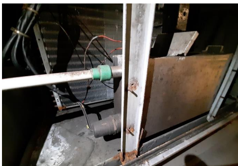
Imagem 109 - Fan Coil danificado
