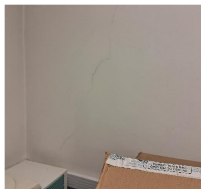
Imagem 37 - Parede trincada NB3
