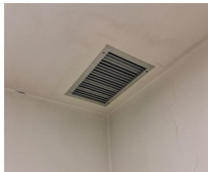
Imagem 35 - Forro e parede com trincas e mofo - NB3
