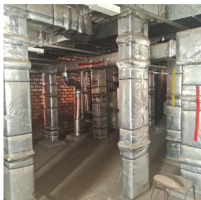
Imagem 77 - Casa de máquinas
