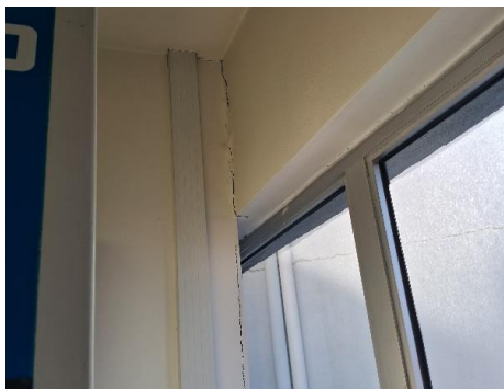
Imagem 7 - Parede trincada e canto esquerdo da sala
