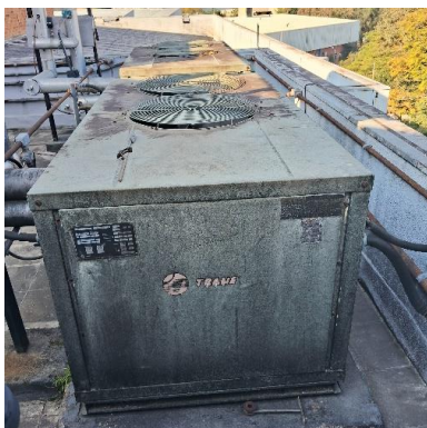
Imagem 56 - Chiller Trane inoperante
