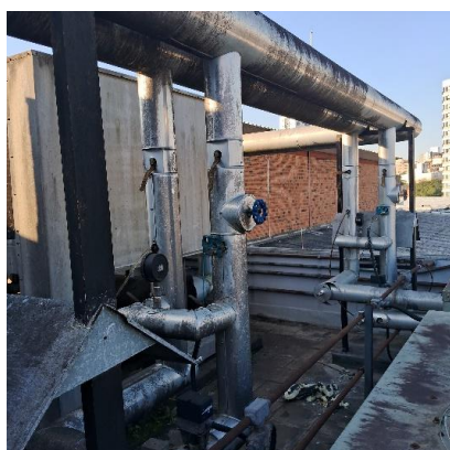
Imagem 66 - Sistema de água gelada inoperante
