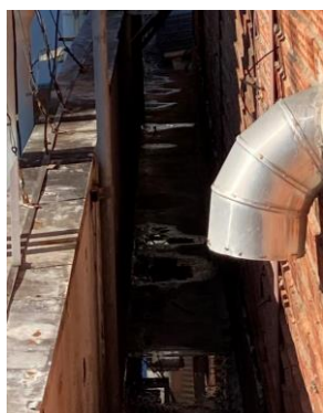
Imagem 72 - Calha com acúmulo de água
