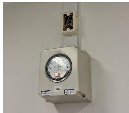
Imagem 18 - Caixa de passagem elétrica sem tampa
