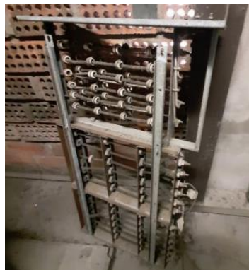
Imagem 111 - Resistência de Fan Coil danificada
