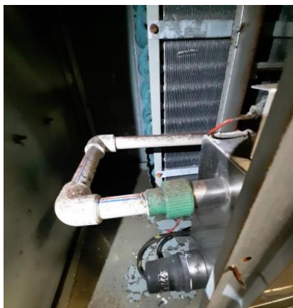
Imagem 115 - Fan Coil Danificado
