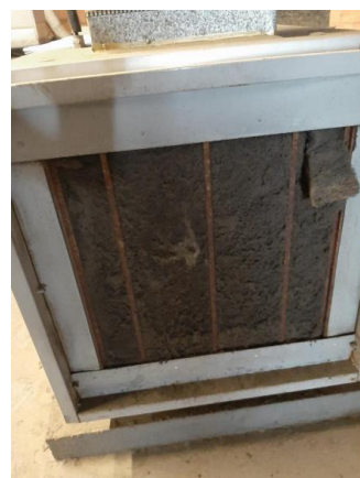
Imagem 116 - Ventilador com filtro saturado
