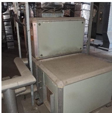
Imagem 85 - Fan Coil 01 - NB2
