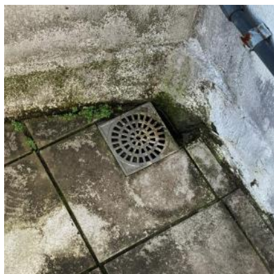
Imagem 68 - Ralo na cobertura obstruído
