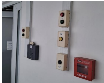
Imagem 27 - Sistema de alarmes e acesso ao NB3
