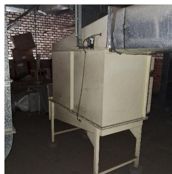
Imagem 102 - Caixa BAGIN / BAGOUT
