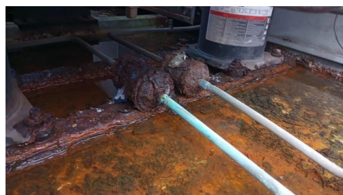
Imagem 65 - Chiller danificado e com acúmulo de água
