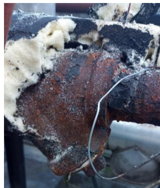
Imagem 63 - Tubulação de água com muita oxidação
