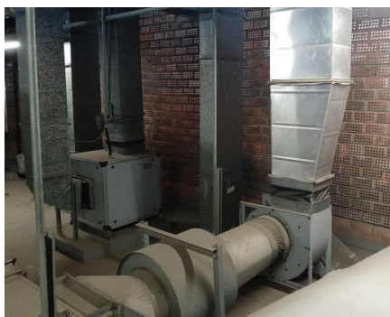
Imagem 117 - Sistema de exaustão
