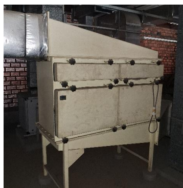
Imagem 100 - Caixa BAGIN / BAGOUT
