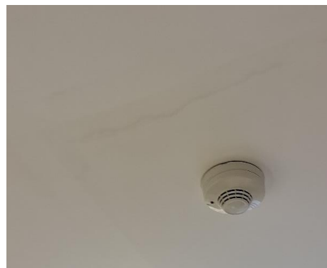
Imagem 6 - Forro de gesso danificado - NB2
