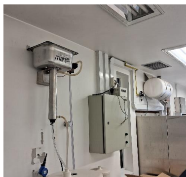
Imagem 47 - Equipamentos da sala de lavagem
