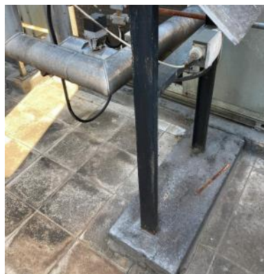
Imagem 69 - Base dos equipamentos com trincas
