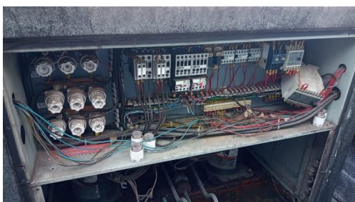
Imagem 64 - Painel elétrico do Chiller danificado
