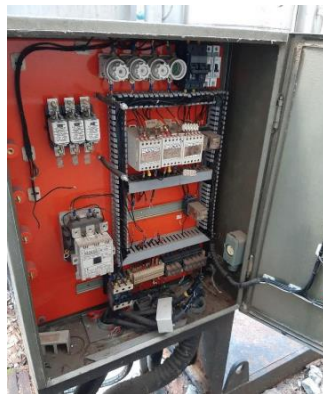
Imagem 129 - Painel elétrico incompleto
