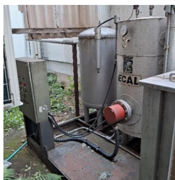
Imagem 122 - Equipamentos da ETE
