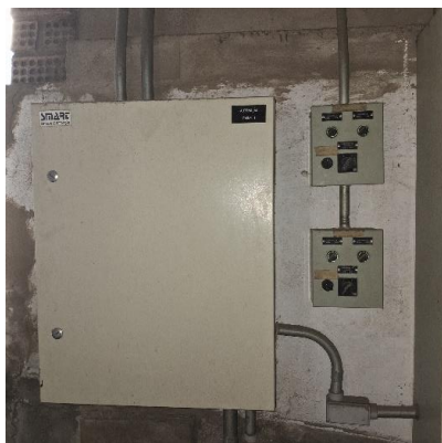
Imagem 91 - Quadro de comando
