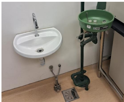
Imagem 11 - Torneira com acionamento ineficiente
