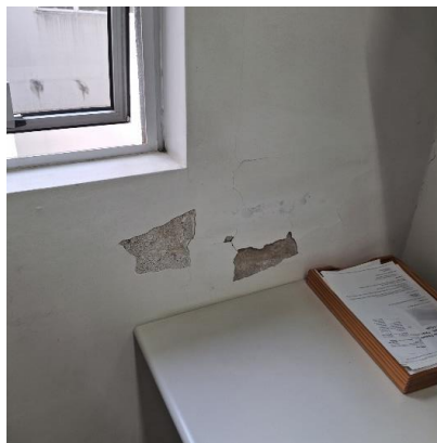
Imagem 132 - Parede com mofo e bolhas
