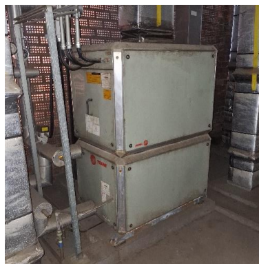
Imagem 86 - Fan Coil 02 - NB3
