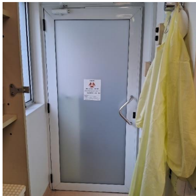
Imagem 24 - Entrada sala eclusa sem vedação perfeita e sistema de acesso restrito.
