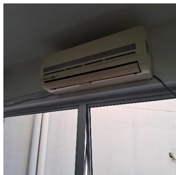
Imagem 133 - Ar-condicionado Split 12.000 Btu/h
