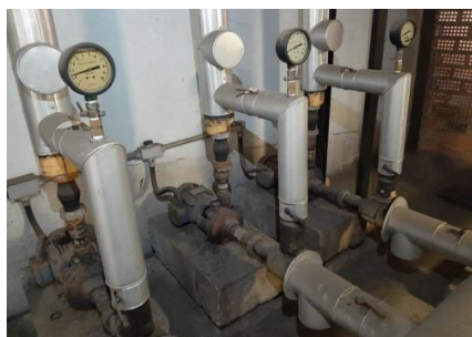
Imagem 81 - Sistemas de bombas
