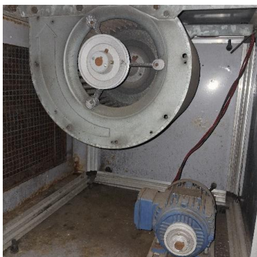
Imagem 97 - Ventilador OTAM danificado
