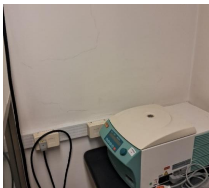
Imagem 36 - Parede trincada - NB3
