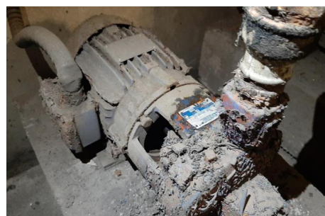
Imagem 82 - Bomba KSB danificada
