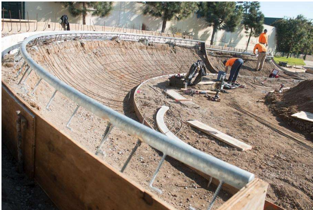
Figura 6 - foto ilustrativa do coping metálico
