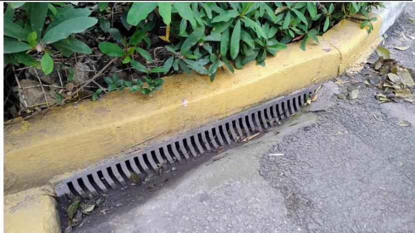
Indicador positivo de entrada ou saída de água sem obstrução.
