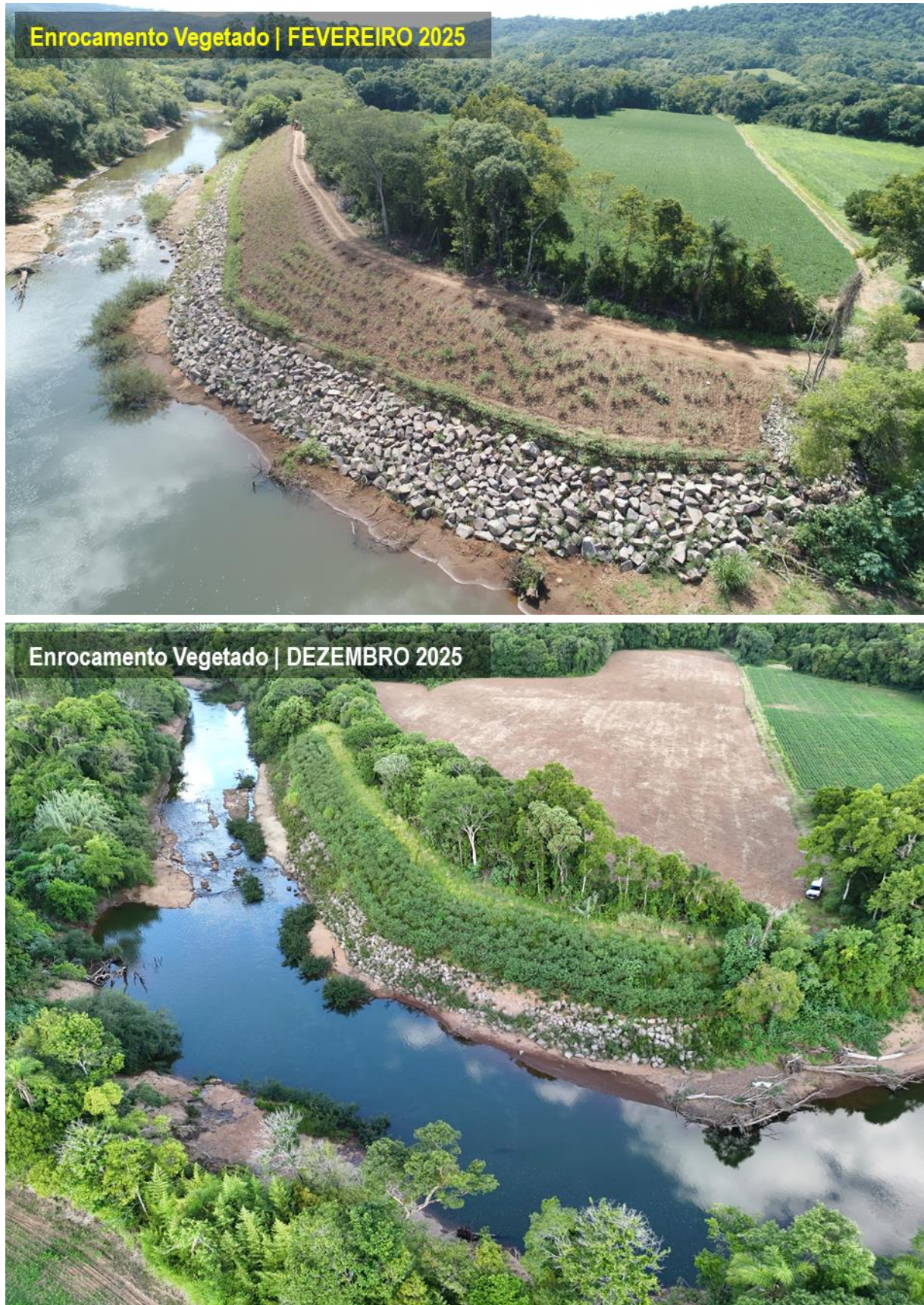
Figura 3. Aspectos gerais da evolução de um enrocamento vegetado após a sua implantação. Obra realizada no rio Pardinho, em Santa Cruz do Sul-RS. Fonte das Imagens: Salix Engenharia Natural, 2025.
