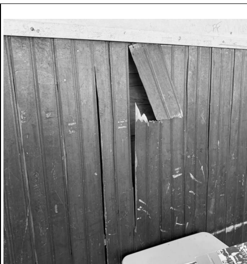
Foto 6 – Dano nas paredes de salas de aula, no bloco 1.
