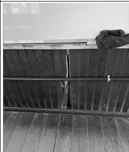
Foto 7 – Dano nas paredes de salas de aula, no bloco 1.
