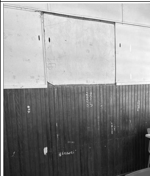
Foto 8 – Dano nas paredes de salas de aula, no bloco 1.
