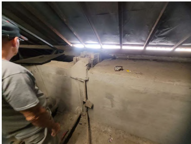
Figura 7: Detalhe tampa aberta do Reserv Sup bloco Mauá;
