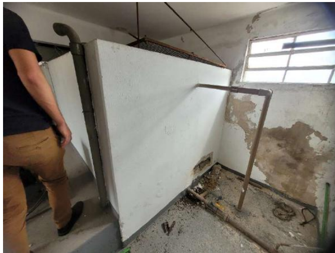
Figura 12: Detalhe lateral de falha na impermeabilização e conexões de saída do Reserv Sup bloco Siqueira;
