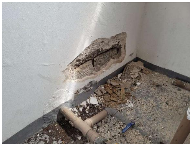
Figura 16: Detalhe de falha de impermeabilização do Reserv Sup bloco Siqueira;
