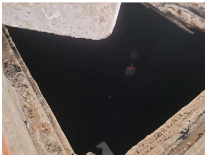
Figura 15: Detalhe interior, bóia, do Reserv Sup bloco Siqueira;
