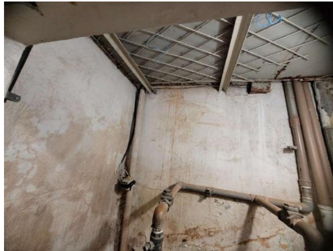
Figura 5: Detalhe das tubulações e conexões de saída para alimentação conexões existentes do Reserv Inf bloco Mauá;
