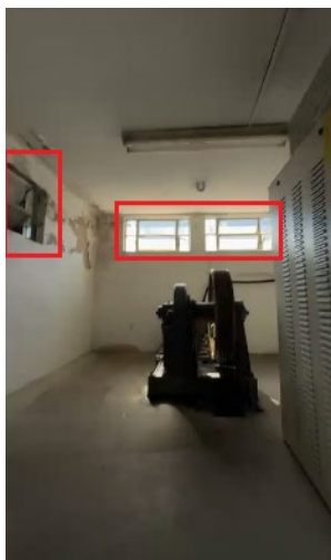
Figura 5 – Janelas a serem removidas e substituídas por venezianas de alumínio.
