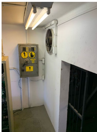
Figura 6 – Quadro geral de energia do elevador existente.
