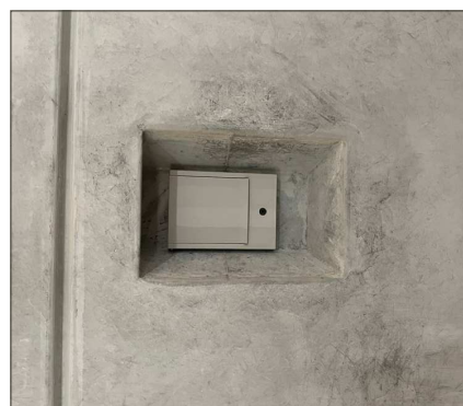
Figura 10- Entrada de Energia Elétrica
