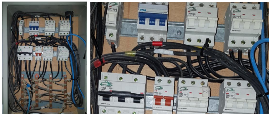
Figura 3 – Ilustração do QGBT existente a ser desativado instalado na parte interna do batalhão.
