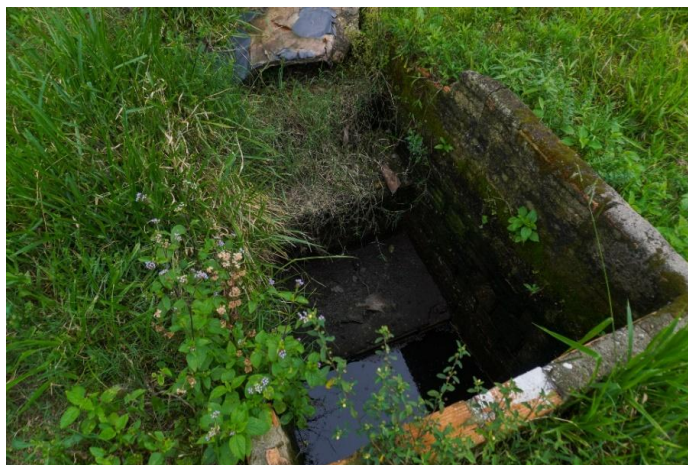
Figura 3. Caixa de inspeção pluvial com esgoto sanitário, sem tampas
