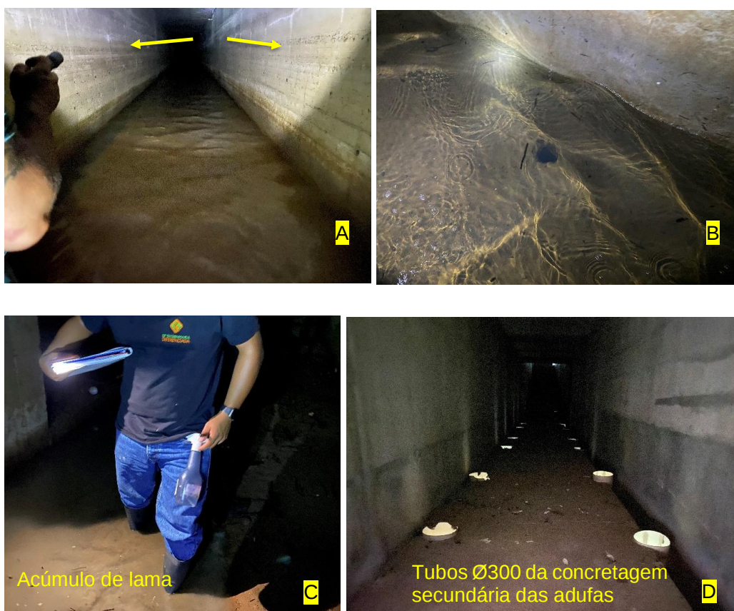
Figura 22 – A. Marcação na parede da variação do nível d'água dentro da galeria. B. Água limpa com depósito de lama no fundo. C. Acúmulo de lama na posição do poço de esgotamento. D. Ambiente seco acima da adufa (tubulações de 300 mm).
