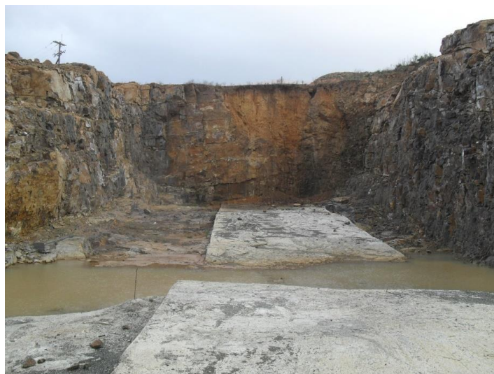
Figura 11 – foto de detalhe da ombreira esquerda durante execução (foto de 2010).
