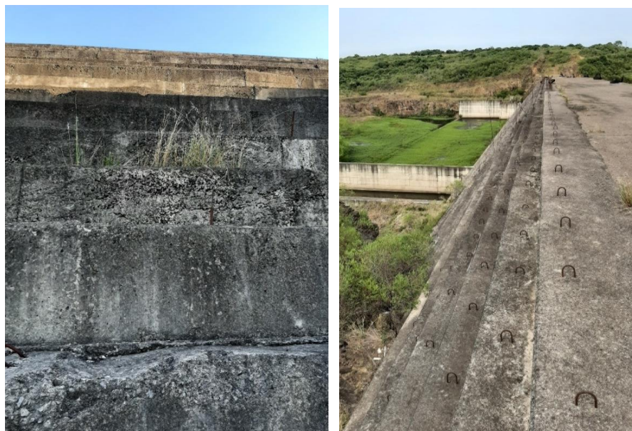
Figura 44 – patologia na face de jusante com concreto poroso. Ganchos para içamento das armaduras expostos.
