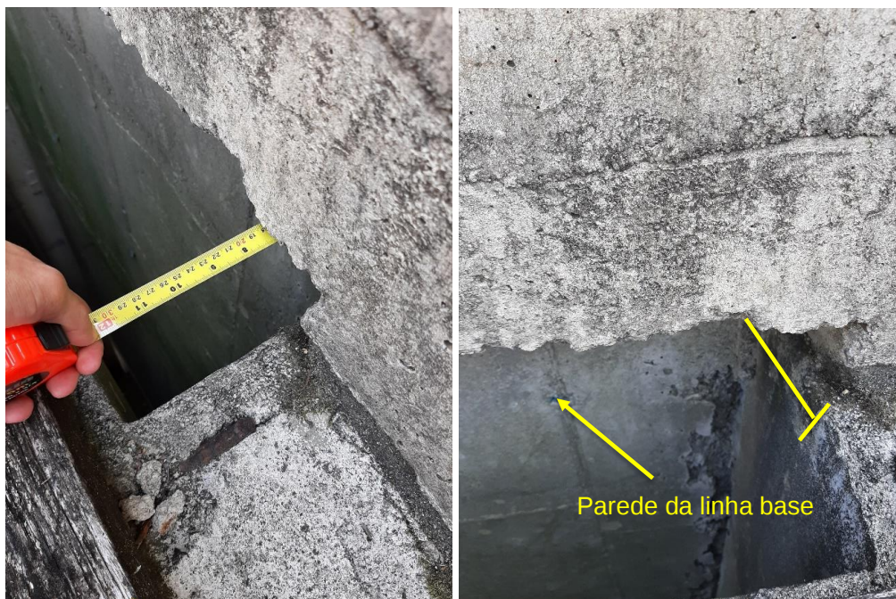
Figura 37 – Detalhe do desalinhamento que dificulta o encaixe das comportas na adufa.
