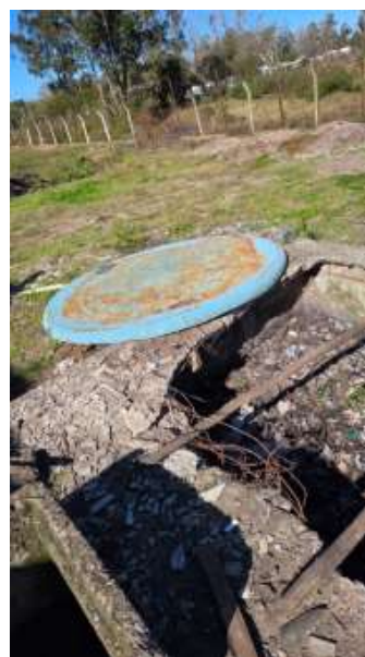
Figura 2 – Resíduos sólidos na rede interna (fossa)
