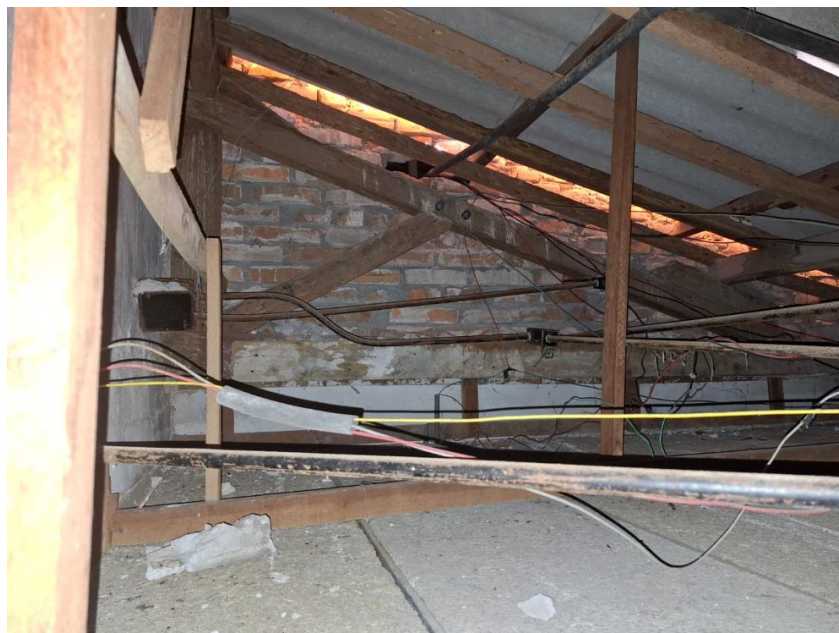
Foto 4: Fiação elétrica solta e aparente sobre o forro, demonstrando as condições precárias das instalações elétricas na área interdita.
