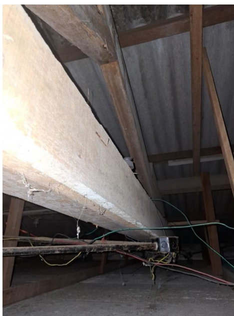
Foto 3: Detalhe da estrutura do telhado, apresentando o madeiramento das tesouras e terças em avançado estado de degradação
