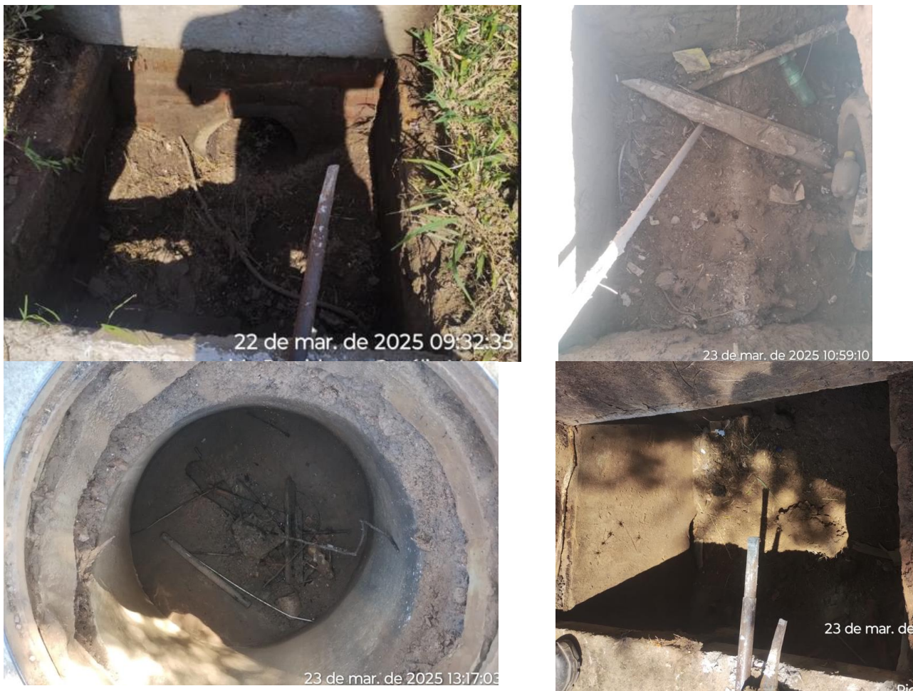
Figura 11 - Poço de Visita assoreado (Registro 22 e 23/03/2025) Fonte – Bourscheid (2025)
