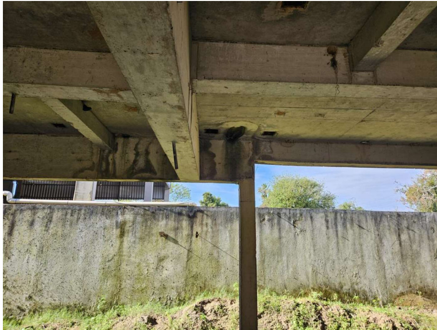
Foto 05 – Pavimento Térreo – Edificação Estrutural Existente - Infiltração
