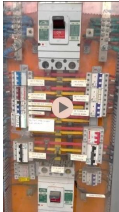
Detalhe QGBT e circuitos
