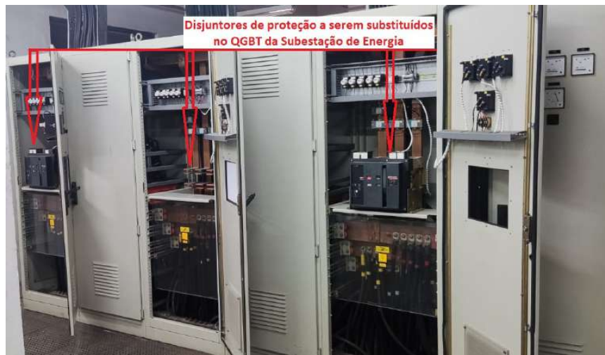
Figura 01: Sinalização dos disjuntores de proteção a serem substituídos no QGBT.
