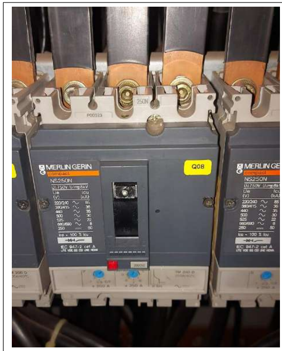
Figura 27 - Disjuntor do QGBT principal
