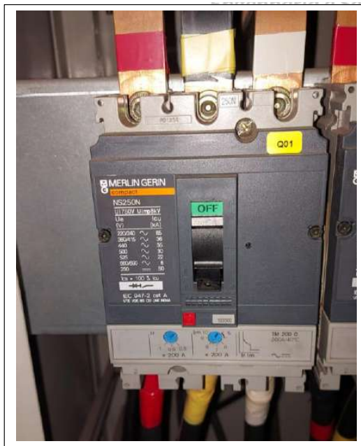
Figura 28 - Disjuntor QTA de emergência
