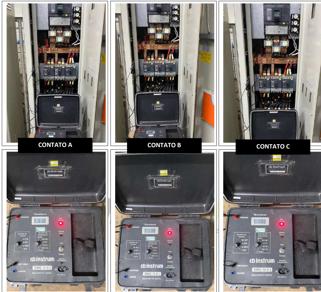
Figura 17 - Resistência de Isolamento entre barramentos Quadro de Emergência
