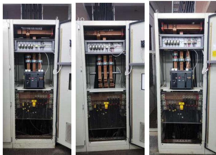
Figura 02: Detalhamento da instalação atual dos disjuntores de proteção.
