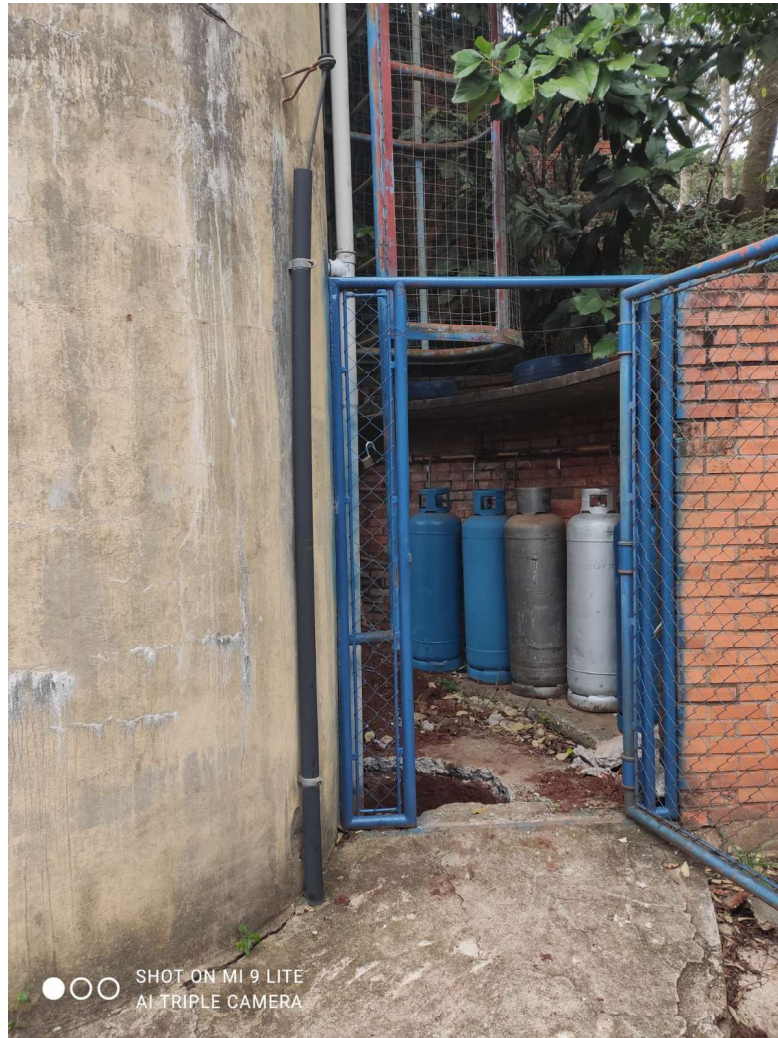
Fig. 4) Central de gás existente
