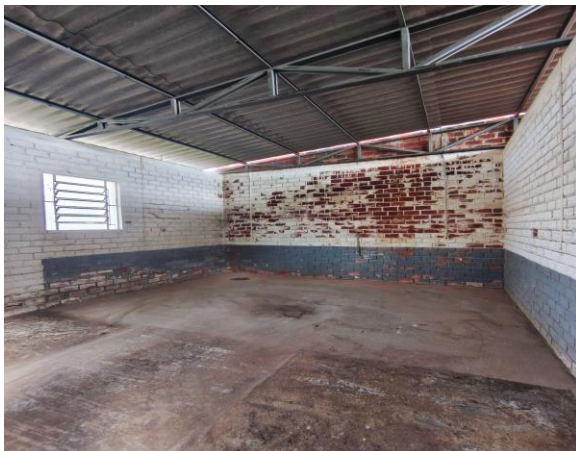
Ausência de Revestimento em Piso - Almoxarifados 01 e 02
