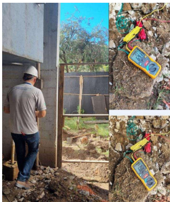
Medição da resistência de aterramento do SPDA CAFF - DESCIDA 2 , R_{t1} = 6,91 Ohms e R_{t2} = 6,80 Ohms, descida em cabo de cobre nú de #95mm 2 .
