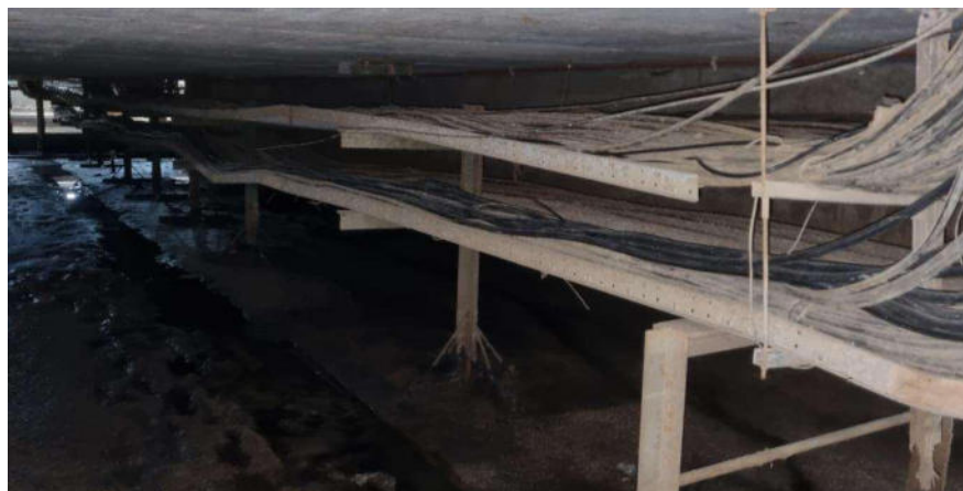
Leitos de cabos que vem da subestação e seguem junto ao teto do subsolo aos Shafts de Elétrica do CAFF e da Procergs.
